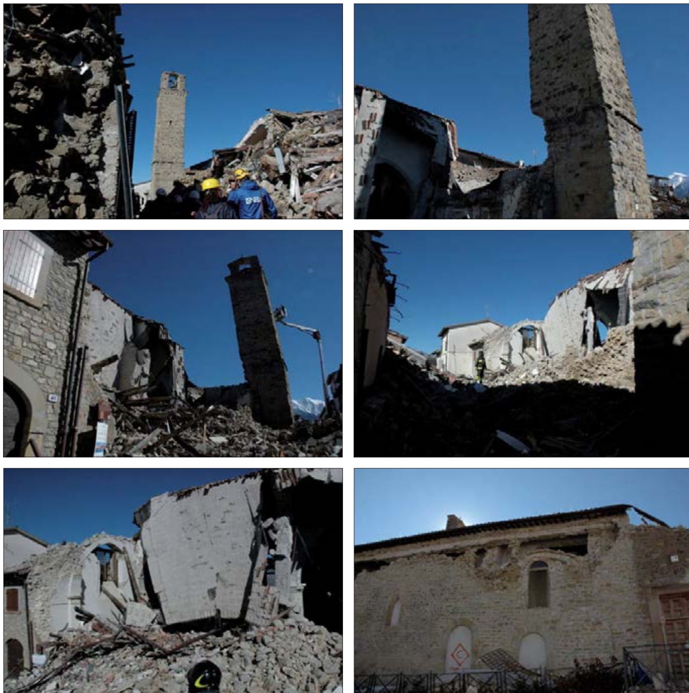
Figura 9 – Chiesa di S. Emidio. Crollo della chiesa e grave danneggiamento del campanile
