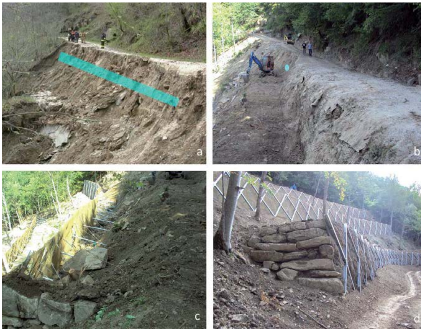
Figura 7 – Cedimento, a causa del sisma, della strada di servizio al di sotto della quale corre la condotta dell'Acquedotto del Chiarino, non visibile nella foto ed evidenziata in celeste (a); interventi di ricostruzione della sede stradale (b) e realizzazione delle opere di sostegno (c) e (d)
