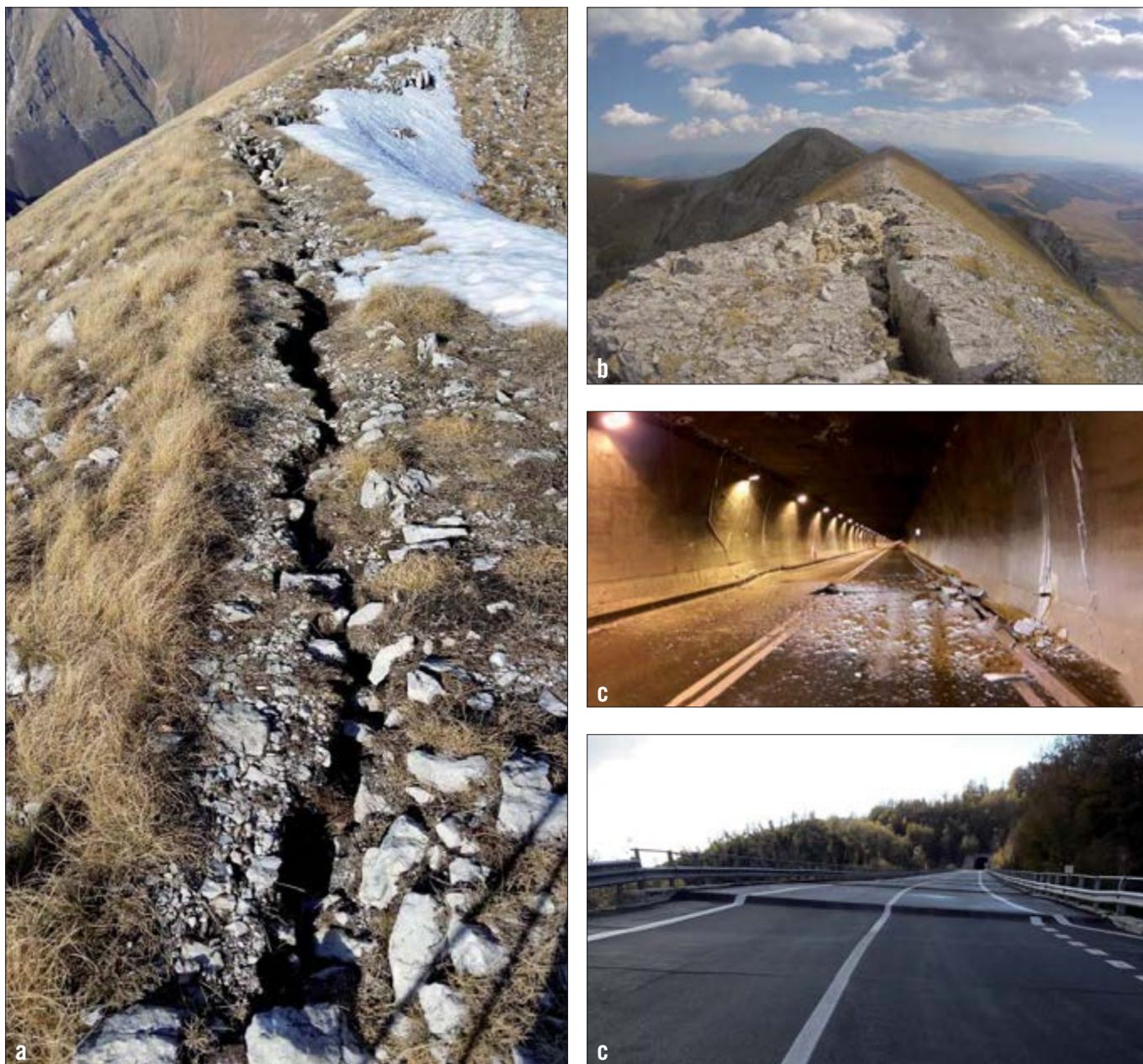
Figura 11 – a) Fratture in cresta a Cima Vallelunga; b) Monte Argentella; c) galleria Capodacqua: la frattura corrisponde alla dislocazione prodotta dalla faglia del Monte Vettore; d) viadotto Capodacqua
