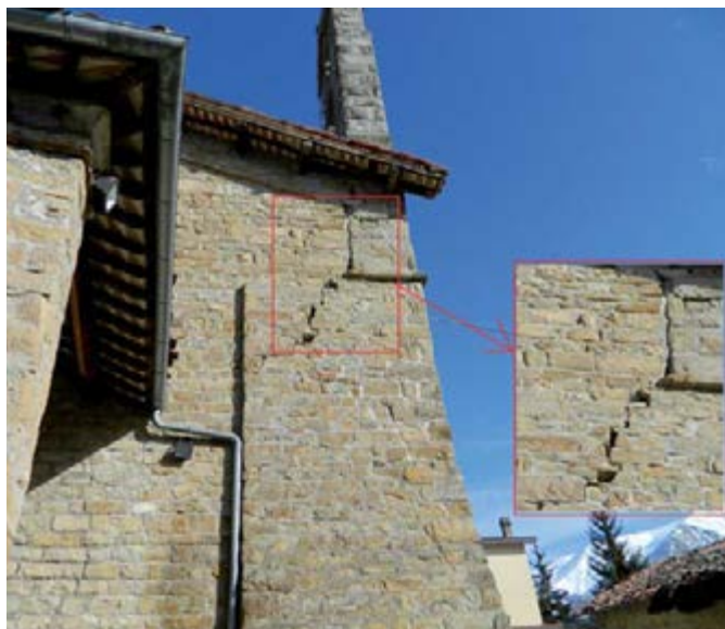
Figura 19 – Chiesa Madonna della Torre: lesioni alla base della vela
