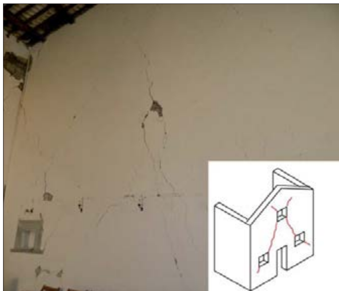
Figura 18 – Chiesa Madonna della Torre: meccanismi nel piano della facciata
