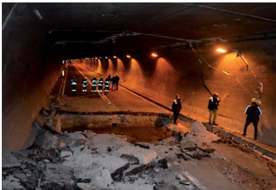
Figura 21 – Lavori per i danni prodotti dalla fagliazione superficiale alla strada delle Tre Valli Umbre (SS685) nella tratta in galleria tra Capodacqua (AP) e San Pellegrino (PG). Foto: D. Spizzichino
