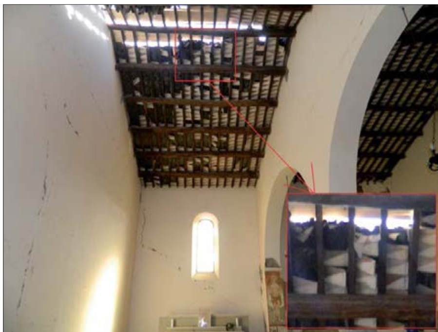
Figura 23 – Chiesa Madonna della Torre: danni in copertura
