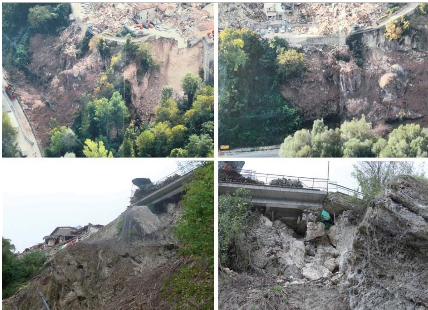
Figura 19 – Il rischio di crolli a seguito del sisma del 24 agosto 2016 sulla SS4 Salaria sotto l'abitato di Pescara del Tronto
