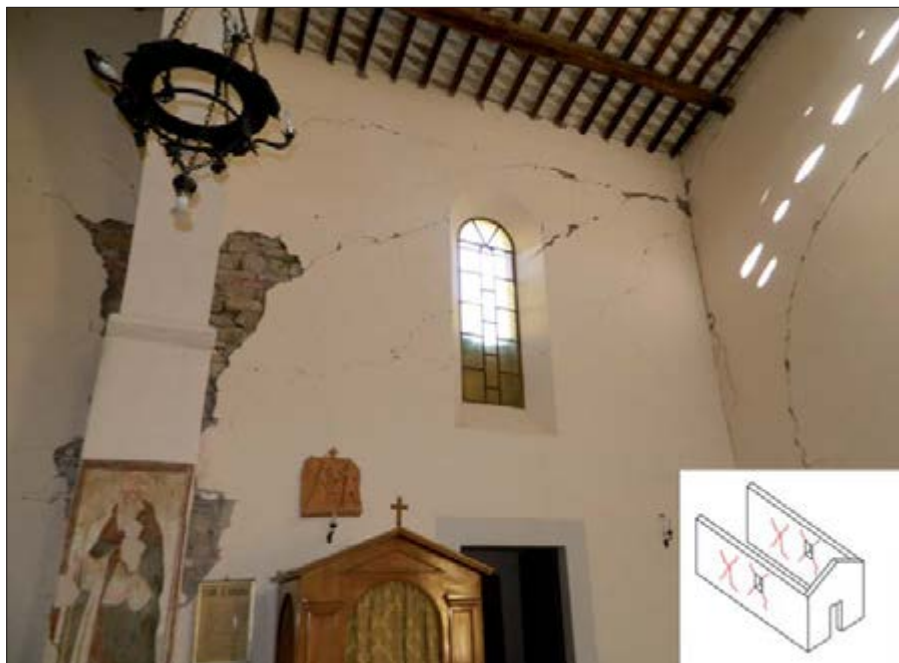
Figura 22 – Chiesa Madonna della Torre: meccanismi di taglio delle pareti laterali
