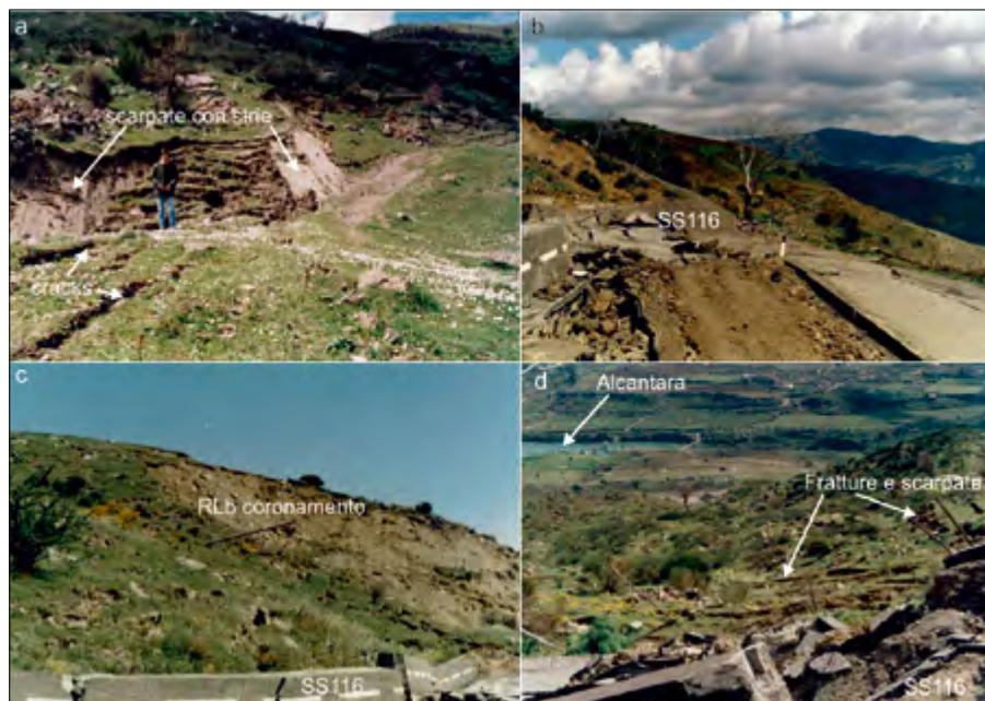
Figura 3. Foto del 1996: a) scarpate a monte del coronamento; b) SS 116 coinvolta nel movimento; c) coronamento; d) vista panoramica da monte (modificato da Pappalardo et al., 2018)
