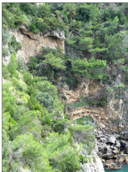
Figura 32. Falesie in erosione (da F. Boccalaro, 2008)
