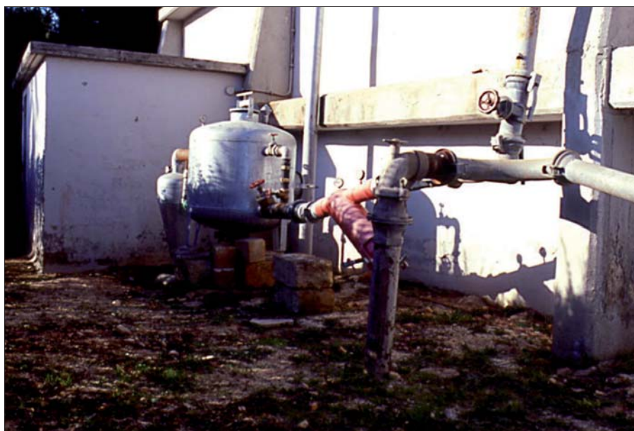
Figura 4 – Stazione filtrante aziendale. In serie: l'idrociclone, il filtro 'a sabbia' e 'a calza'
