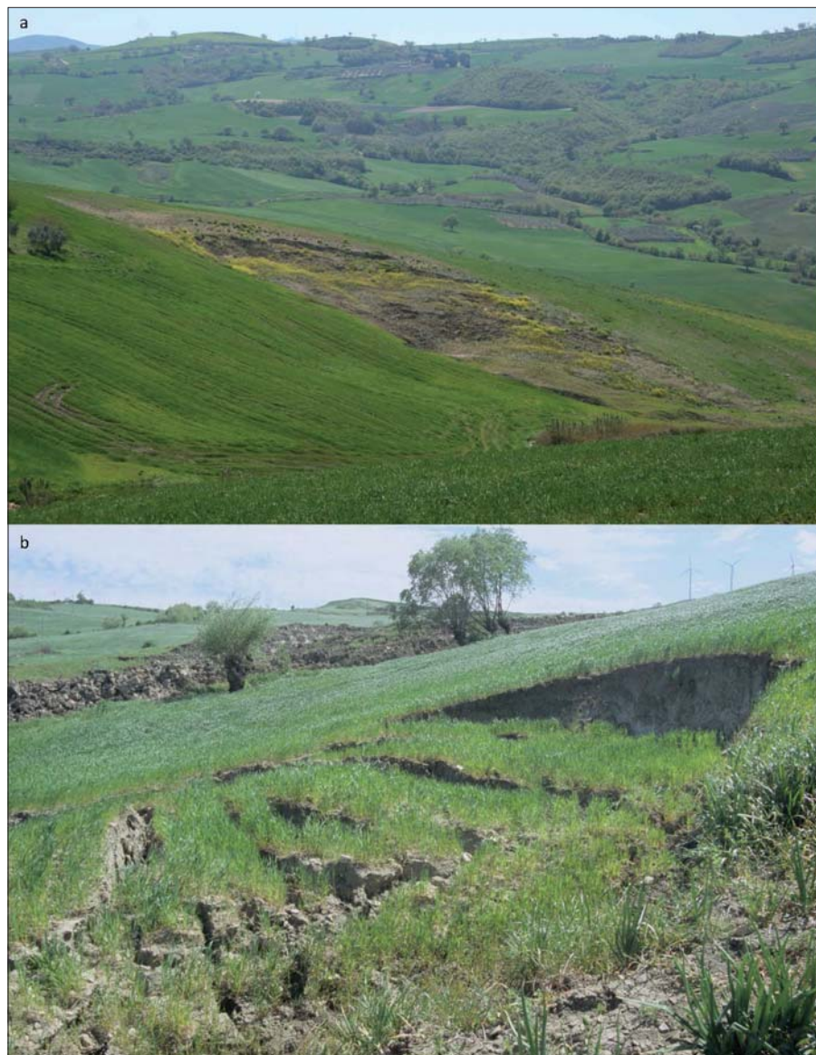
Figura 1 – a) Scivolamento superficiale evolvente a colata su tipico pendio del Sub-Appennino Dauno; b) Coronamento di una frana per scorrimento-colata lungo la strada Accadia - Panni (foto dell'11 maggio 2005)
