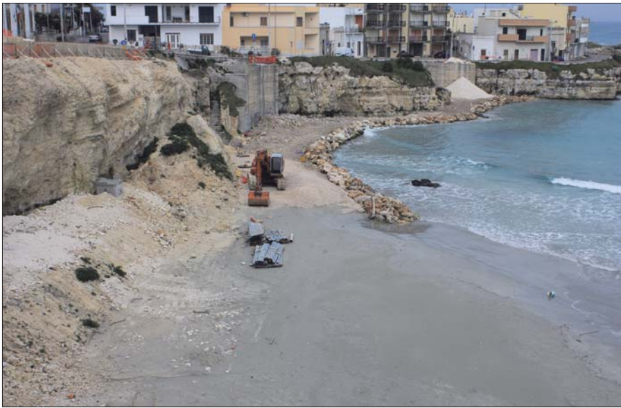
Figura 3 – Vista da Sud a Nord della falesia durante i lavori di consolidamento statico e riqualificazione costiera
