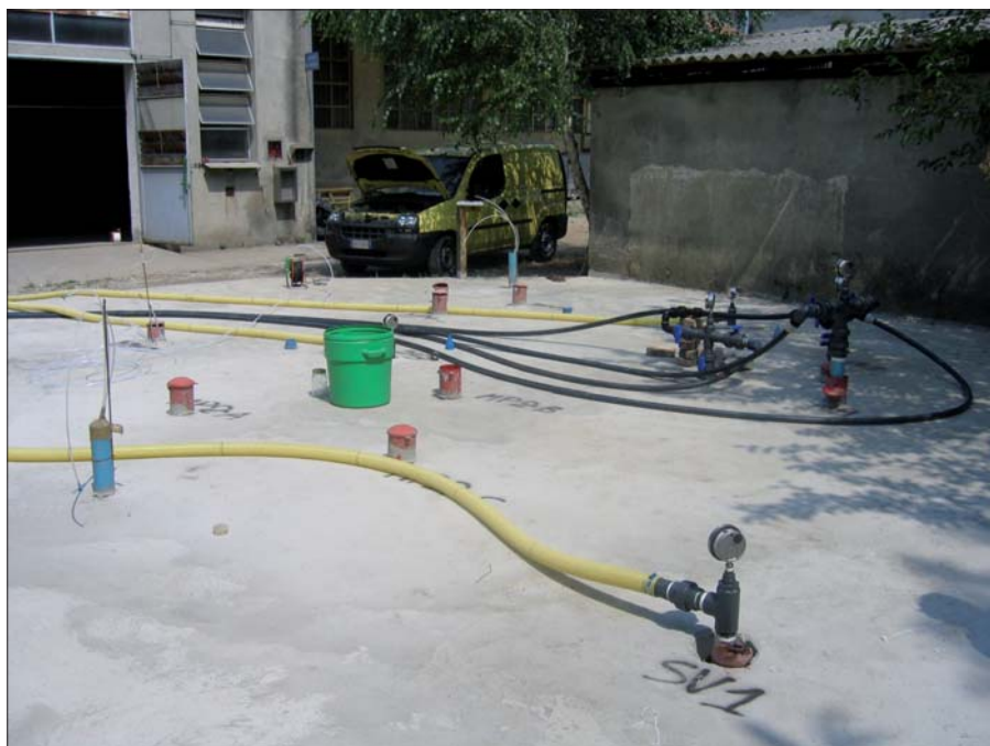
Figura 6. Particolare dell'Impianto SVE Installato
