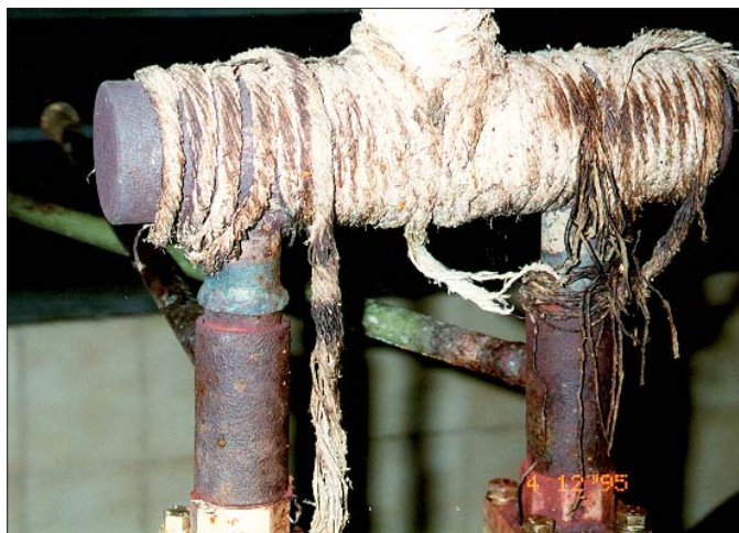
Figura 13. Corde di amianto attorno a tubazioni
