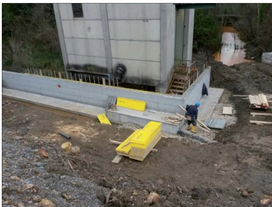
Figura 16. Fase di realizzazione del cordolo attorno alla sala pompe per permettere l'innalzamento del piano campagna circostante
