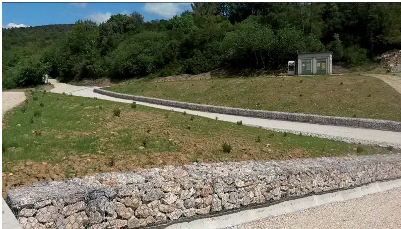
Figura 19. Vista da S della parte di accumulo con la cabina elettrica sul piazzale superiore. A sx è possibile vedere la pista di accesso allargata e riprofilata con materiale stabilizzato
