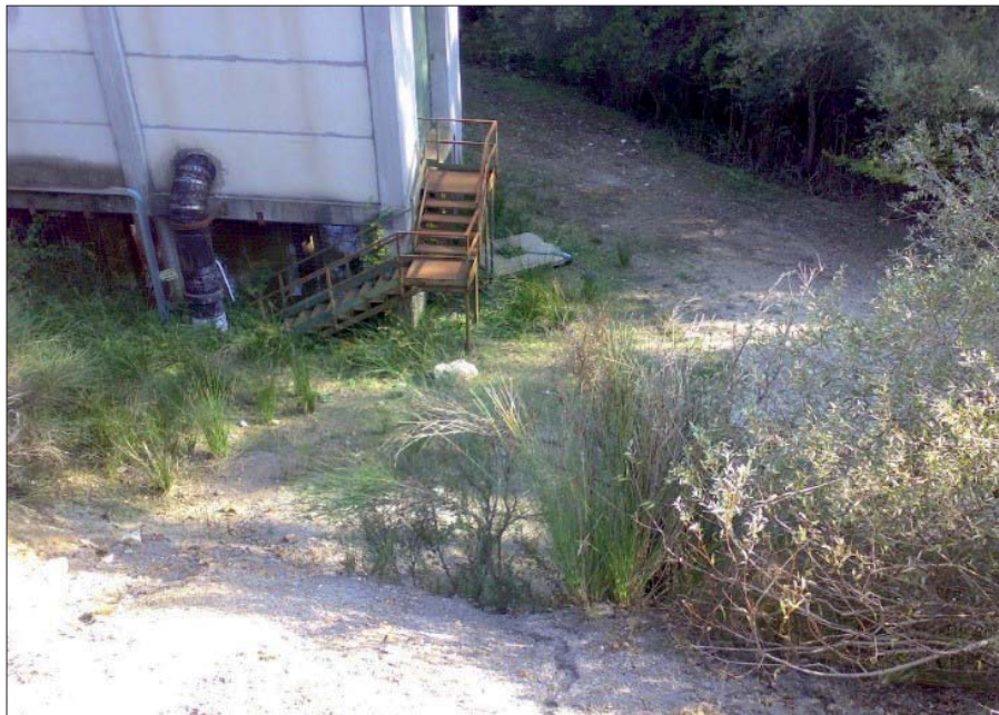
Figura 8. Vista 3 particolare stazione di sollevamento con condotta acquedotto in uscita prima dell'interramento
