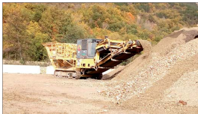
Figura 8. Impianto di recupero R5
