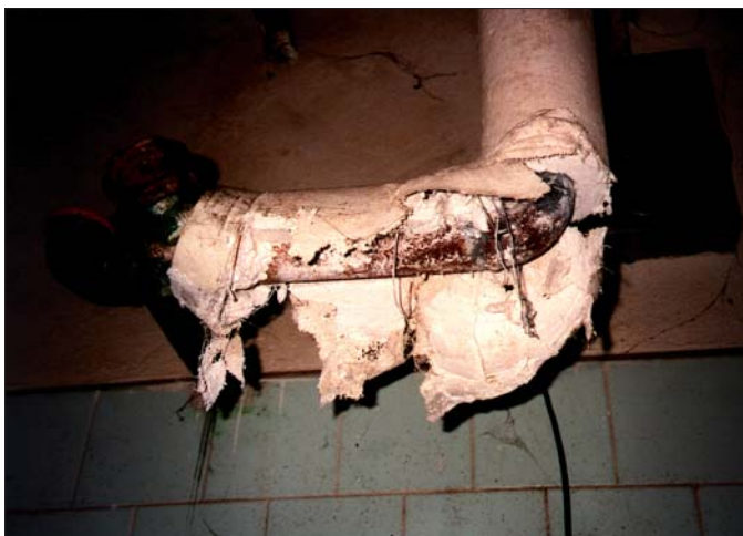
Figura 12. Rivestimenti multistrato di tubi, con malte cementizie contenenti amianto
