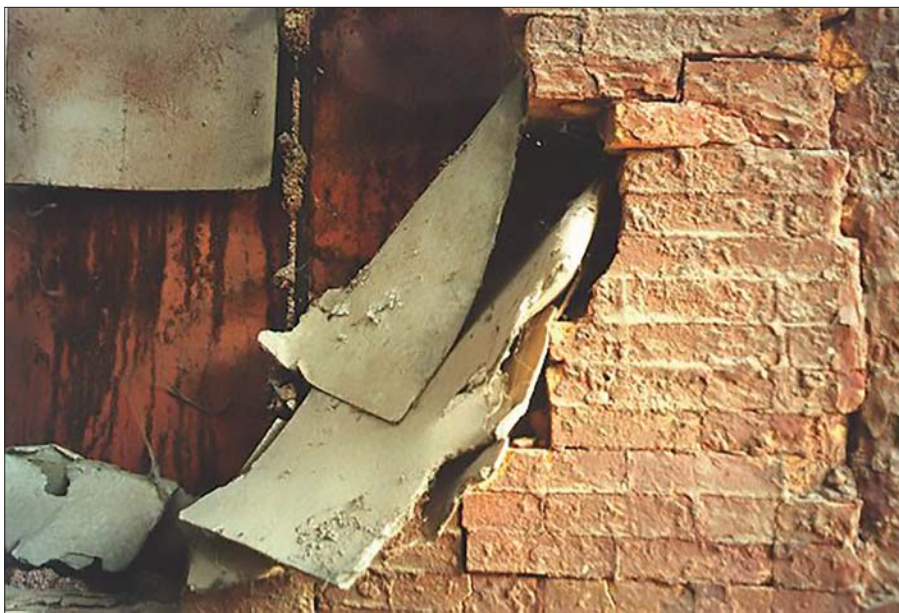
Figura 11. Cartoni di amianto in strutture edilizie
