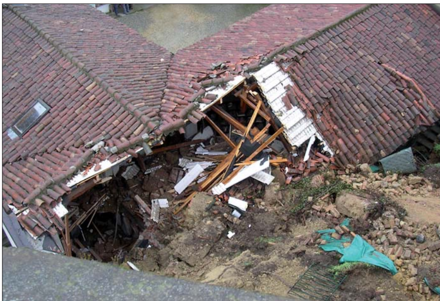
Figura 16 – Danni causati dal crollo del muro medievale nel concentrico di Castelnuovo Don Bosco, (marzo 2011).
