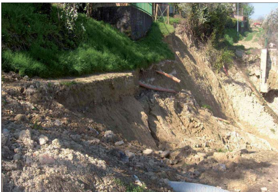
Figura 11 – Scarichi di condotte fognarie e di gronda degli edifici hanno favorito l'innesco della frana di Casorzo (marzo 2011)
