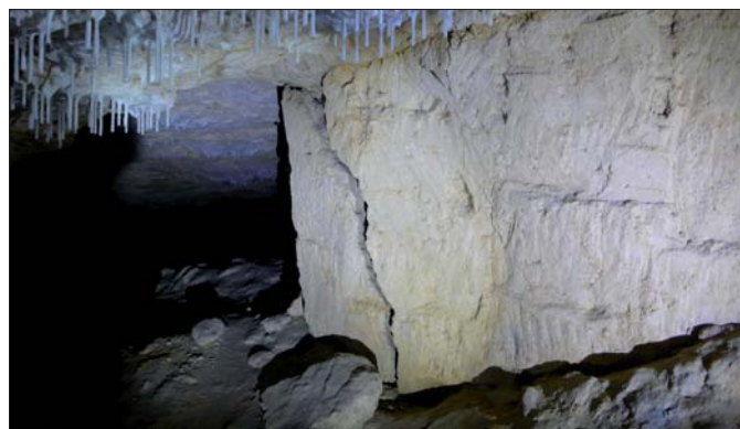
Figura 9 – Pilastro con fratturazione.
