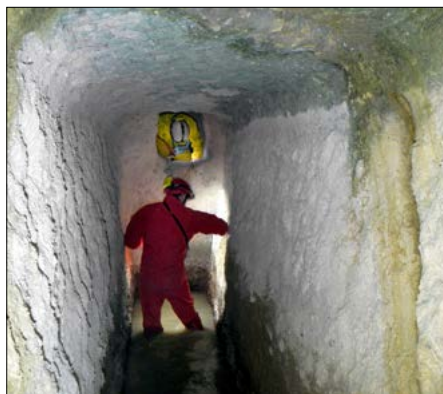
Figura 9 – Cunicolo-cisterna "Belvedere". La camera di prelievo con il passo d'uomo che, scavalcando la diga, permette l'accesso al condotto (Foto A. Bixio)
