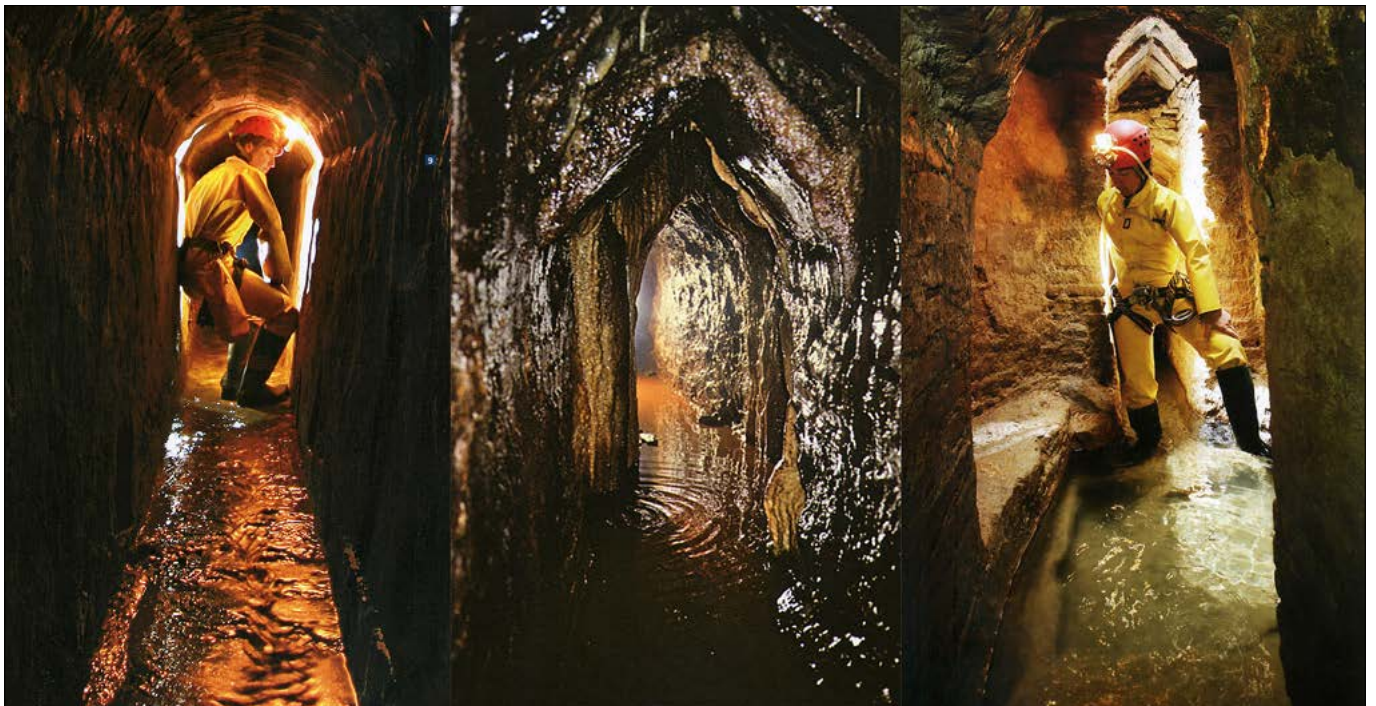
Fig. 5: Alcuni tratti dei cunicoli, si notino le sezioni di "specus" con rivestimento del cavo parziale/totale realizzato con tecnica mista: pietra, laterizio e roccia (Foto G. Antonini)
