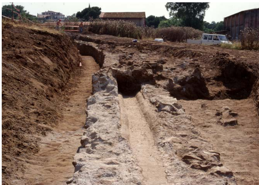
Figura 3 – Crolli dei muri di contenimento del canale (foto dell'autore)
