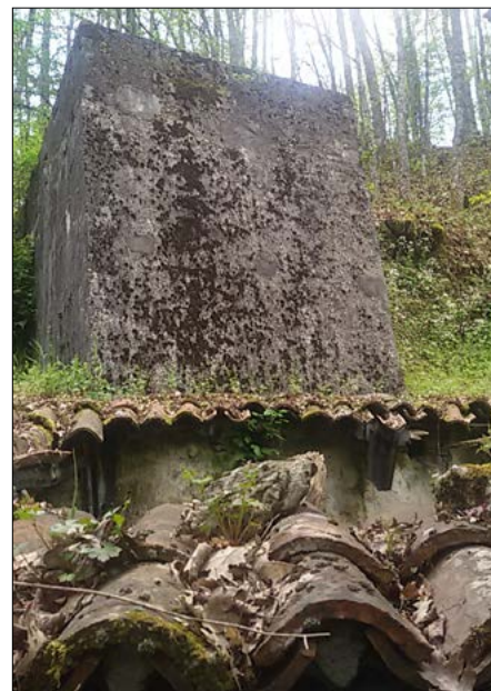
Figura 6 – Mulino Magnacane a Viggianello (Pz), danni al tetto rilevati nel corso di un sopralluogo nel 2016
