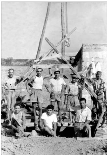
Foto 1 – Un momento dei lavori dello scavo di un pozzo a Rocca di Capri Leone agli inizi degli anni '50.
