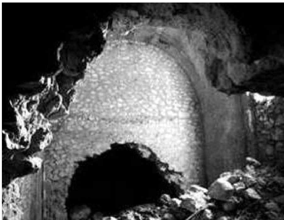
Figura 19 – Interno Cisterna cimitero Vallecupa venafro
