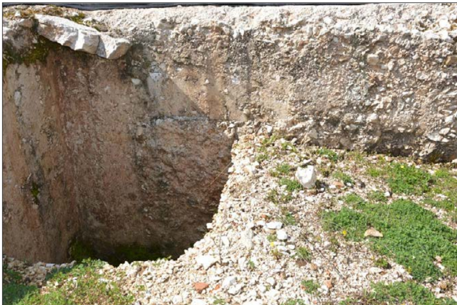
Figura 5 – Particolare dell'angolo SO della vasca in cui è ben visibile il raccordo tra la gettata in cavo e quella in cassaforma
