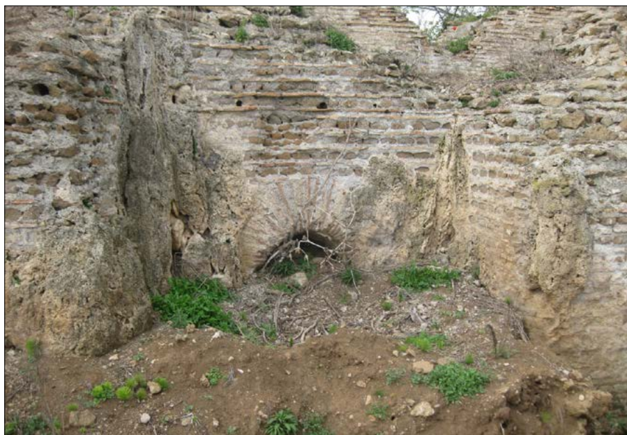
Figura 6 – Contrafforti in opus vittatum furono aggiunti nel IV sec. d.C. Gli enormi depositi calcarei sono causati dalle perdite di acqua
