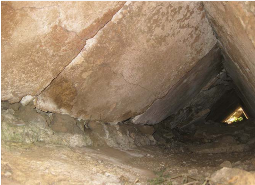
Figura 8 – Con l'impiego di bipedali a cappuccina la costruzione diventò meno pesante. Sopra il vuoto a sezione triangolare seguono cementizio e il nuovo specus. Vista interna.
