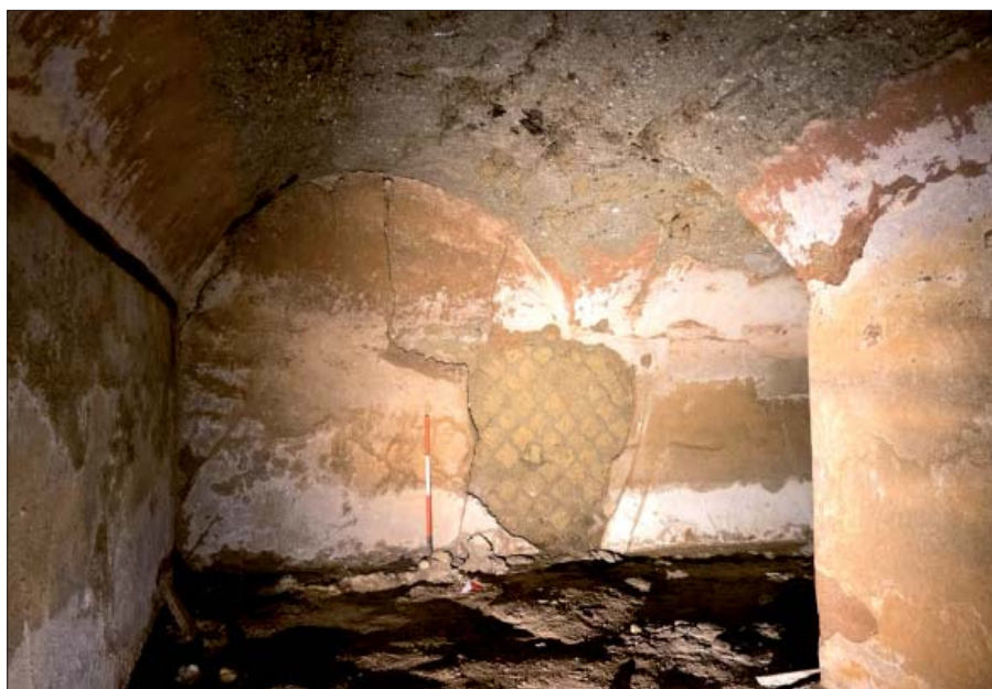
Figura 6 – Angolo Nordovest della Cisterna II. Sotto l'intonaco caduto appare il paramento murario in opera reticolata. Foto N. Damiano
