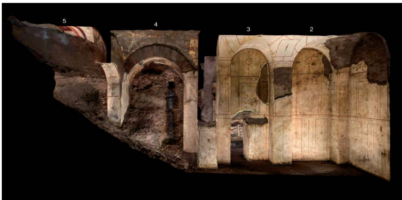
Figura 10 – Vista prospettica delle pareti nord-est degli ambienti 2, 3, 4, 5 della Privata Traiani domus (elaborazione da rilievo fotogrammetrico tridimensionale di S. Calò, E. Santucci)
