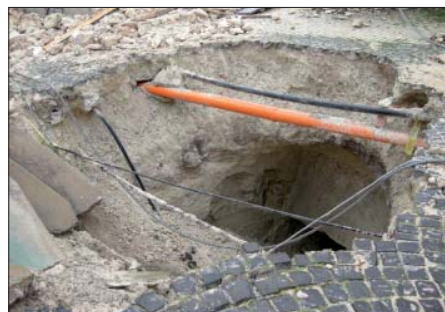
Figura 1 – Sprofondamento di una cavità a seguito del terremoto del 6 aprile 2009 nel centro abitato di Castelnuovo, frazione di San Pio delle Camere (AQ)
