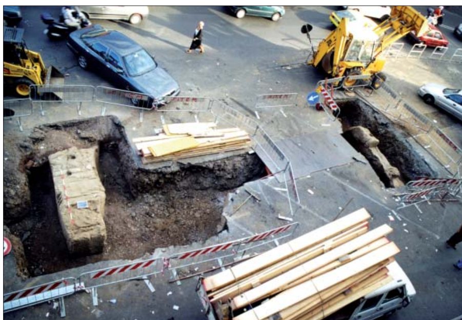
Figura 24 - Panoramica dei due testimoni di cava di Tufo lionato rinvenuti in un cantiere per la posa di cavi in fibra ottica di fronte all'ex-Drugstore in Via Portuense 319
