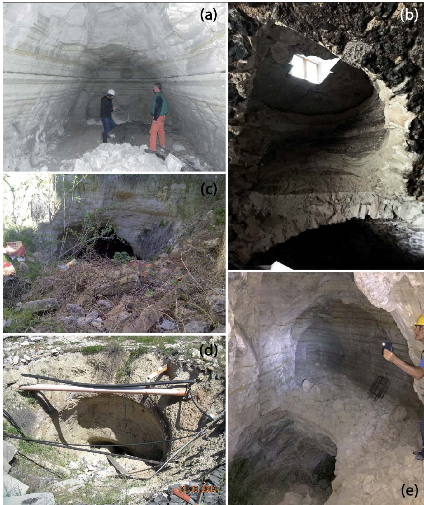
Figura 7 – Testimonianze di crolli a seguito del sisma del 2009: in tutte le cavità censitesi sono osservati crolli diffusi di porzioni di volta o di pareti (a), che hanno a volte rappresentato una concausa dei cedimenti degli edifici soprastanti (b). In alcuni casi si è assistito al cedimento totale delle volte, con l'apertura di voragini in superficie (c, d), che hanno destato notevole stupore nell'immediato post-sisma. In un caso si è osservato il crollo di un diaframma che sostituiva la separazione di due cavità sovrapposte verticalmente (e)
