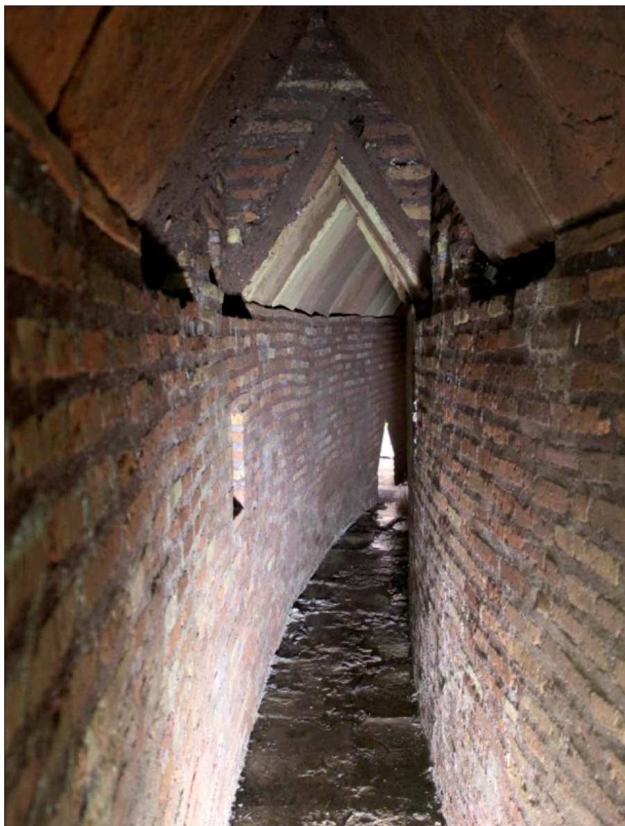
Figura 7 – Esempio di condotto idraulico del sistema di deflusso delle acque del Mausoleo di Romolo
