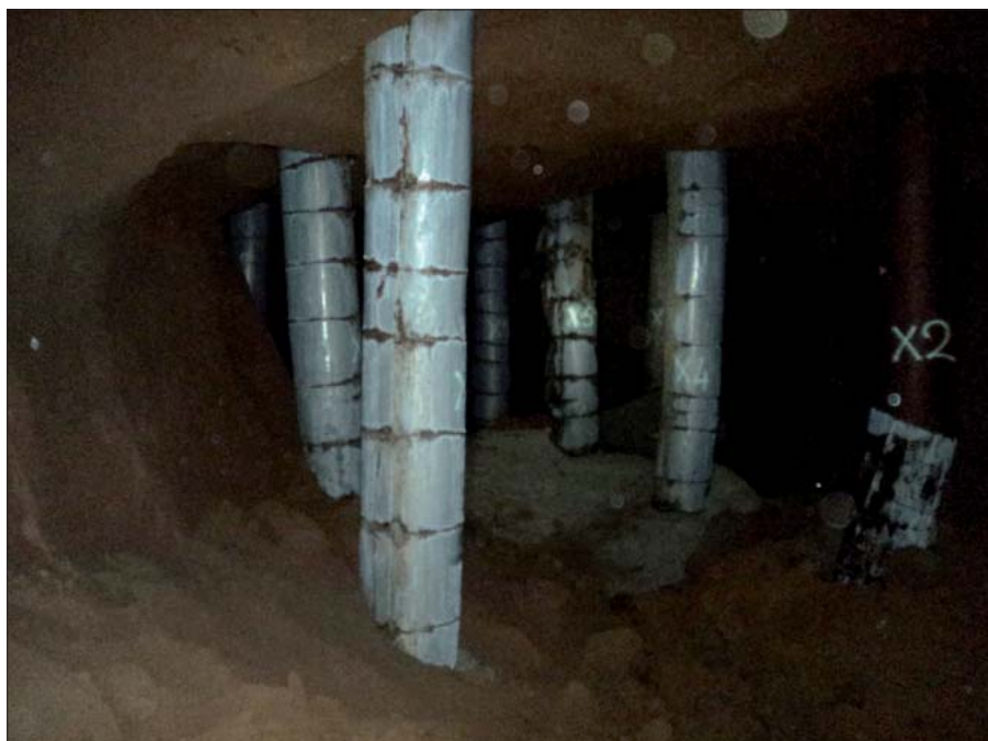
Figura 3 – Pali di fondazione nelle cave sotto Villa de Santis (foto M. Piro)
