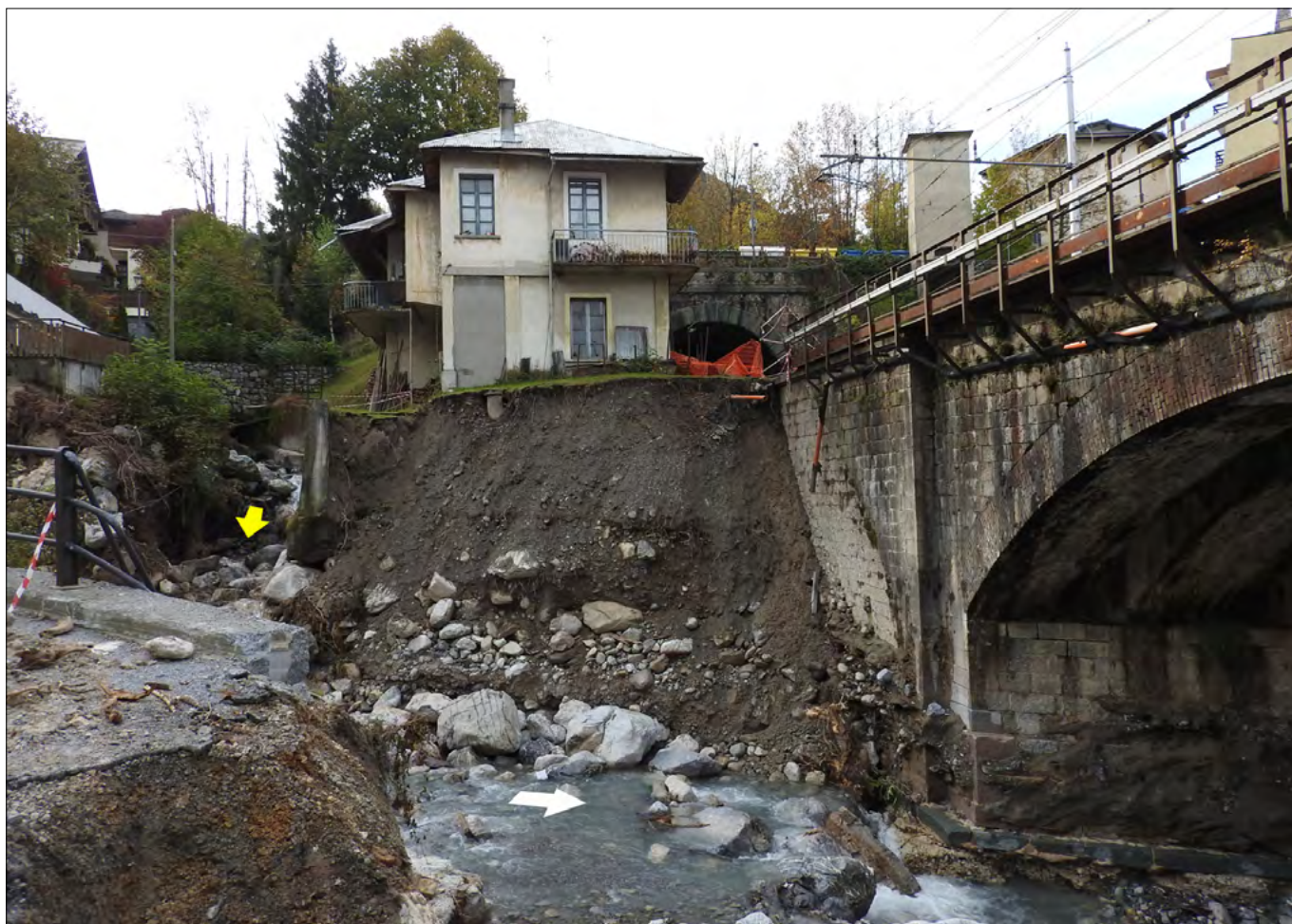
Figura 197. Il Rio Milliboro (freccia gialla), dopo un tortuoso percorso fra le case, sfocia con una confluenza perpendicolare nel T. San Giovanni (bianca). La fotografia è scattata presso la spalla destra del ponte ferroviario: si notano ampie erosioni spondali lungo il T. San Giovanni e lesioni agli edifici attigui e alla viabilità (foto Turconi).
