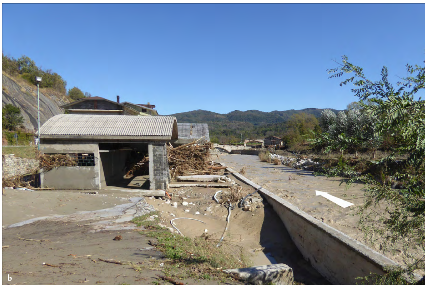
Figura 39b. Bagnasco. Capannoni industriali inondati (visti da monte) in sponda sinistra: è visibile un ingente volume di materiale legnoso accatastato contro e all'interno dell'edificio (foto Luino). Anche questa costruzione subì danni ingenti nelle precedenti piene del Tanaro. Sullo sfondo il ponte romano.
