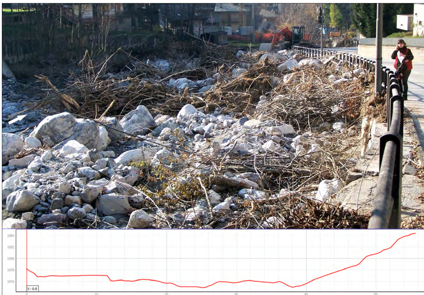
Figura 190. Torrente San Giovanni in cui l'ampiezza dell'area di deflusso della piena del 2 ottobre è risultata pari 216 m 2 (44°12'03.25"N 7°34'58.20"E) con sormonto della strada comunale (Viale Valleggia, di fronte al civico n. 57) su cui si sono accatastati volumi ingenti di detrito vegetale (foto Tropeano ed elaborazione mediante rilevamento del modello di terreno di Eurodrone). In secondo piano è visibile la casa gravemente lesionata e basculata in alveo.
