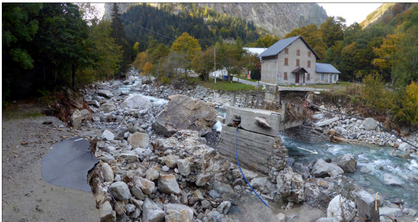
Figura 82. Terme di Valdieri: opera di attraversamento gravemente danneggiata. Dalle Terme Reali di Valdieri il ponte consentiva di raggiungere il Vallone del Valasco (foto Luino). Coordinate: 44°12'20.16"N 7°16'14.22"E.
