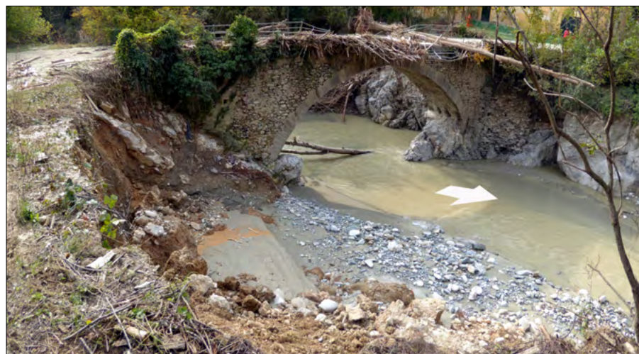
Figura 79. Valcasotto: ponte sul T. Casotto ( 44^{\circ}21'21.99''N , 7^{\circ}54'15.71''E ) nel territorio del Comune di Torre Mondovì. L'opera di attraversamento è stata sormontata e parzialmente lesionata: la sponda destra, immediatamente a valle, ha subito una profonda erosione.
