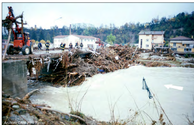
Figura 120. Ceva, 6 novembre 1994: ponte della SP 225. Le due pile in alveo trattengono molto materiale flottante favorendo il sormonto e la diversione delle acque di piena (foto Luino).
