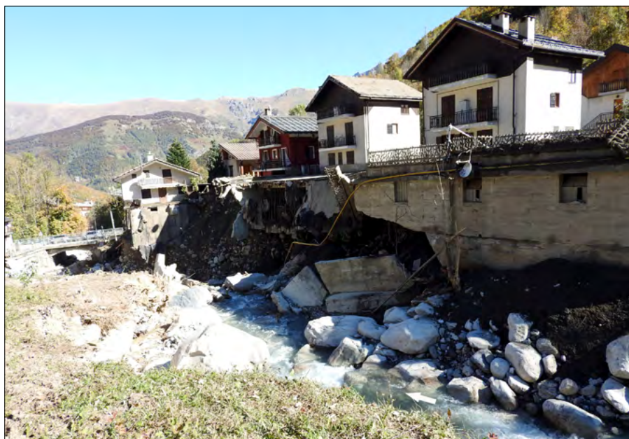
Figura 165. L'infelice posizione del villaggio Tetti Mecci è stata evidenziata dalla piena e dai relativi danni che si sono creati per la capacità erosiva del T. Vermenagna: cantine, garage e i relativi cortili di pertinenza che si appoggiavano sopra sono stati asportati (foto Turconi). A sinistra nella fotografia, il ponticello della SS20 che ha resistito alla piena.
