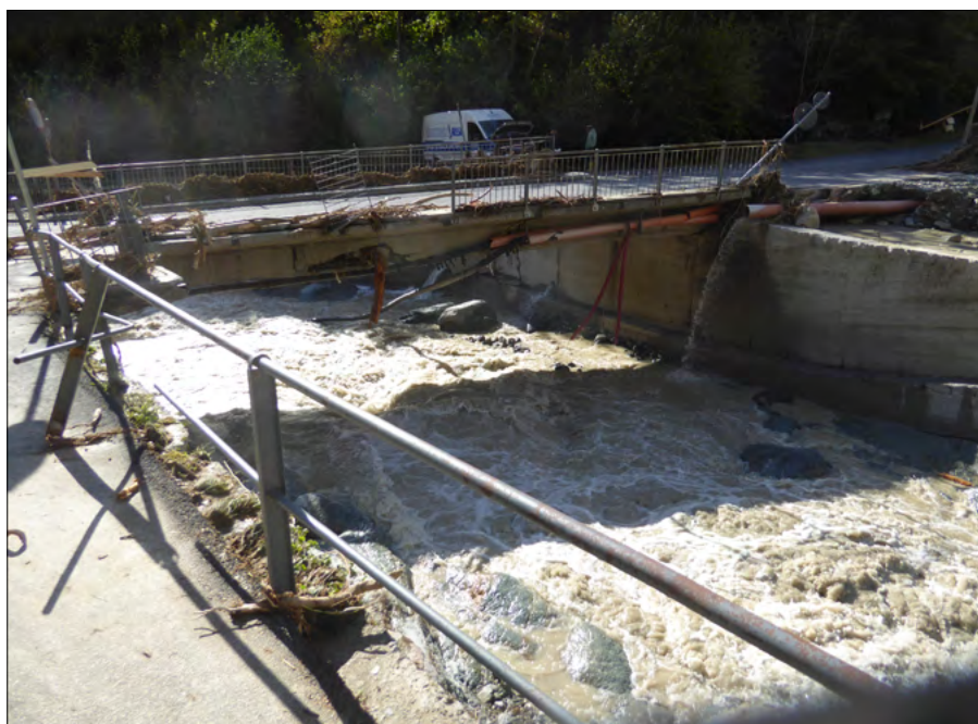
Figura 32. Ormea: ponte sul T. Armella a monte del paese (foto Luino). Verso le ore 2 del 3 ottobre (secondo gli abitanti intervistati) il torrente ha inondato l'abitato trasportando molto materiale flottante. Le acque hanno asportato le ringhiere dei ponti e sono penetrate con forza entro i locali delle case ubicate lungo le sponde (lama d'acqua di 20 cm circa). L'Armella è un torrente con un bacino di 17,6 km 2 considerato storicamente molto pericoloso.
