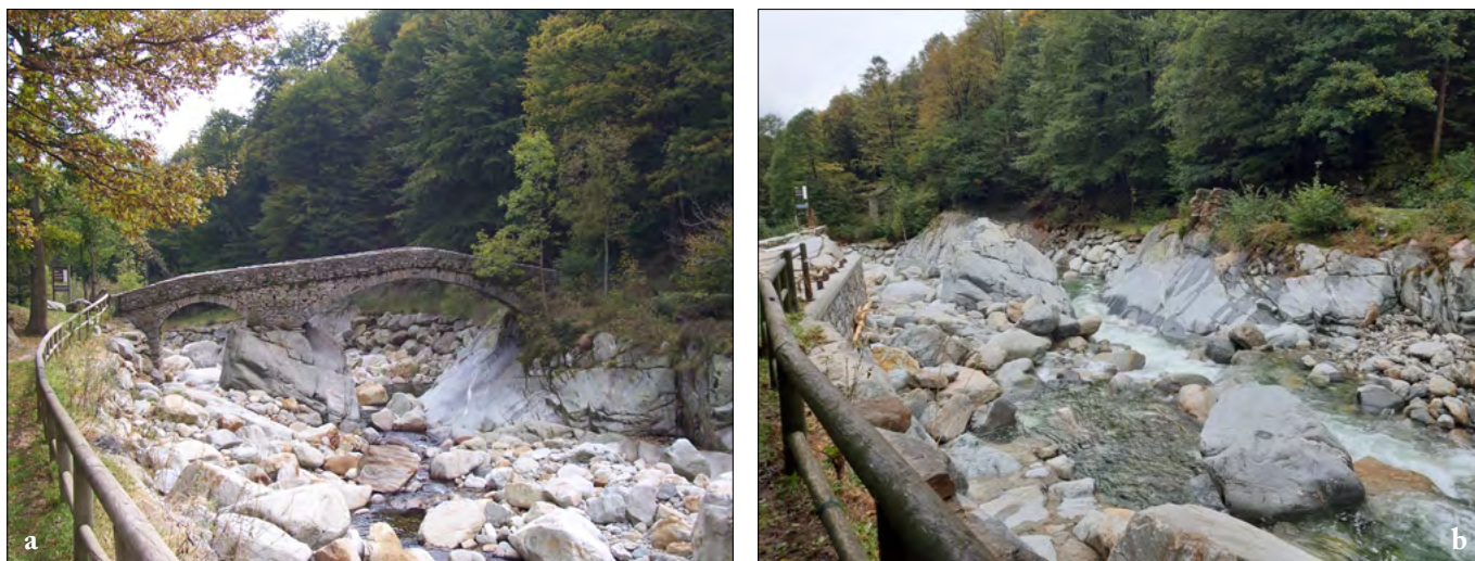
Figura 238. Piedicavallo, il ponte pedonale della Coda: a) prima e b) dopo il passaggio della piena del Cervo.
