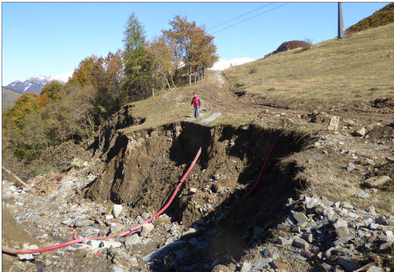
Figura 160. Rio Salauta, immediatamente a monte del piazzale della seggiovia Morel (lato Limonetto). Dettaglio del grado di approfondimento dell'impiuvio, superiore a 6 m (foto Turconi)(coordinate 44°9'39.31"N 7°33'06.29"E).
