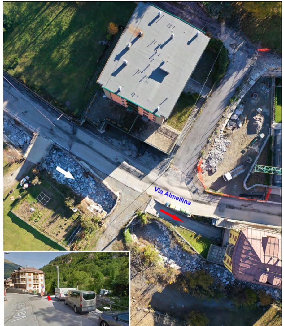
Figura 216. Limone Piemonte, Via Almelina. Due attraversamenti con luce decisamente insufficiente, costruiti in cemento armato e pietre, sovrappassano il T. Almelina (freccia bianca). A circa un metro di distanza dall'alveo, diviso da un sottile setto (cfr. fig. 199a), è stata realizzata una discesa ai garage del condominio (freccia rossa). Quest'ultimo, come si intuisce chiaramente dalla visione dall'alto, ha invaso e ristretto l'alveo originale del torrente (foto Eurodrone).
