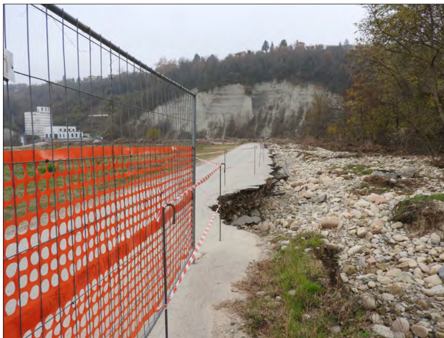
Figura 59. Erosione, asportazione e danni alla strada di accesso alla centrale Edison di Farigliano, sulla sponda destra del Tanaro (foto Silvestro).
