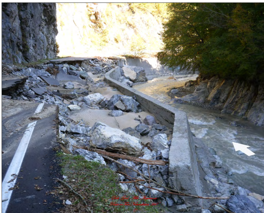
Figura 30a. A monte di Ponte di Nava, al km 4 della SP154, le acque del Tanaro hanno nuovamente asportato un tratto della strada, nel medesimo punto che era già stato lesionato nel novembre 2016 (44°07'20.42"N 7°49'28.93"E)(foto Acquarone).
