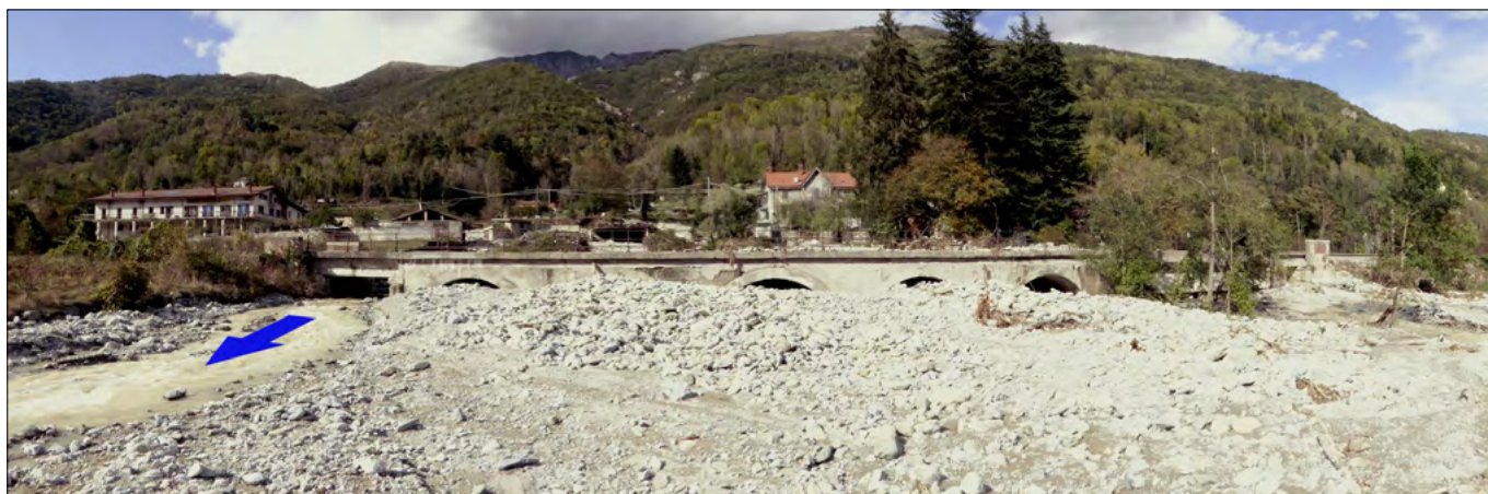
Figura 33. Sabato 3 ottobre: ponte ferroviario sul Rio Peisino (area 5 km 2 ), ripreso dalla strada statale 28 (foto Luino).
