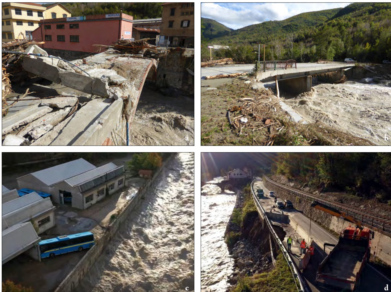
Figura 35. Ormea: a) ponte della Cartiera sul Tanaro, sormontato e danneggiato (foto Luino); b) ponte dei Barchi: asportate e lesionate le ringhiere (foto Luino); c) Ormea: deposito dei pullman inondato. Le acque hanno trascinato ed incastrato un automezzo che ha dovuto essere sollevato nei giorni successivi da una grossa gru posizionata sulla sponda opposta (frame da volo drone GEDI Visual); d) erosione spondale del Tanaro che ha danneggiato la SS28, all'altezza della Cartiera di Ormea (frame da volo drone GEDI Visual).
