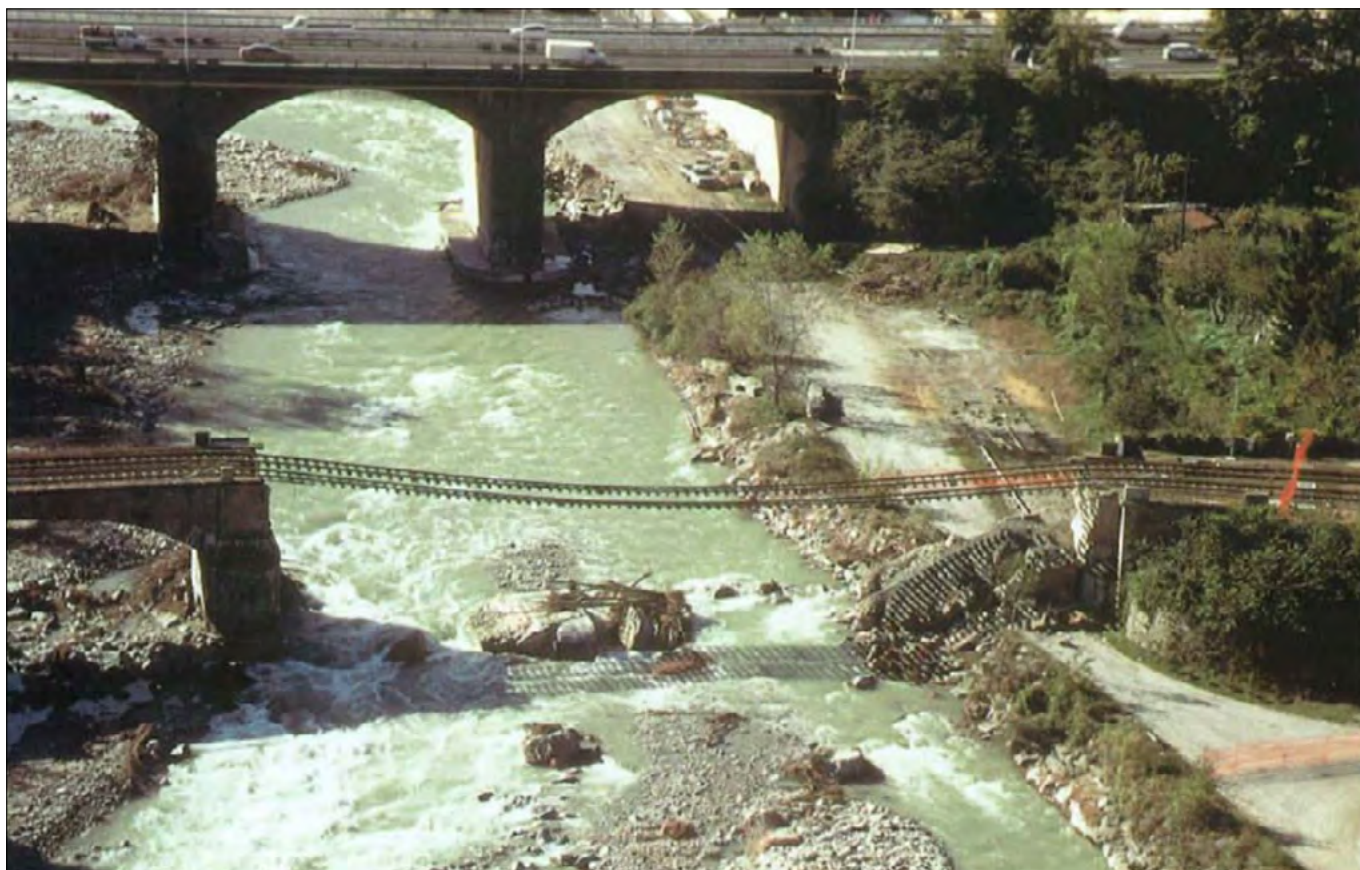
Figura 141. Cuneo. Ponte ferroviario della linea Cuneo-Mondovì crollato per la piena del Gesso dell'ottobre 1996 (Regione Piemonte, 1999).
