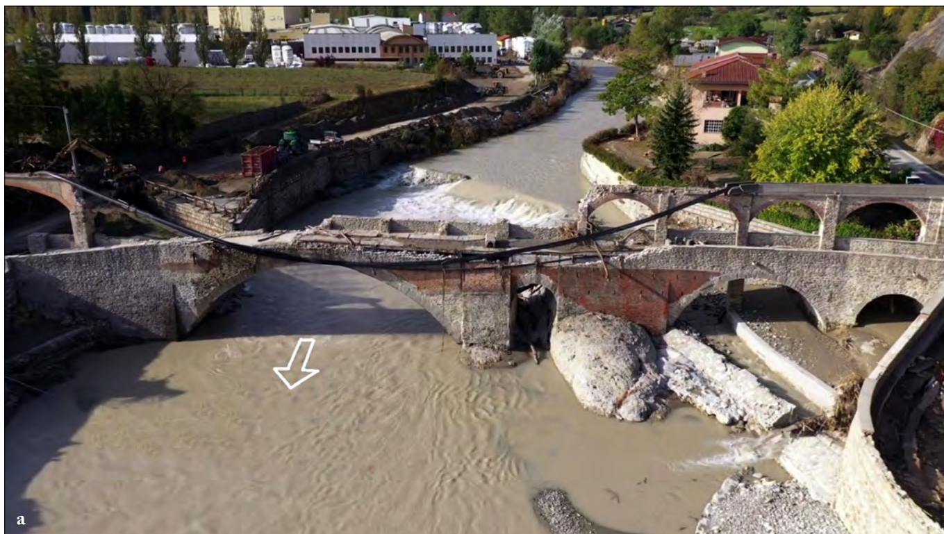
Figura 39a. Tanaro (vista verso monte), ripreso dal drone di Arte.tv. Ponte romano di Bagnasco, già parzialmente lesionato dalla piena del novembre 1994, ha resistito anche in questa occasione. Sulla destra, a monte dell'opera di attraversamento, è visibile una casa gialla, ripetutamente inondata durante ogni piena del fiume, in particolare modo nel 1994. Nella recente piena, però, i proprietari hanno affermato che il livello delle acque è stato addirittura superiore a quello di 26 anni prima, avendo raggiunto il soffitto del pian terreno. A onor del vero è anche doveroso sottolineare come, in questo tratto, le arginature costruite successivamente all'evento del 1994 abbiano ristretto sensibilmente la larghezza dell'alveo.
