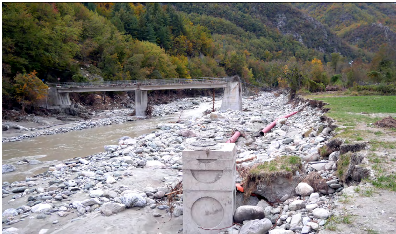
Figura 37. Fiume Tanaro. Ponte per la frazione Villarchiosso con asportazione della strada d'accesso (44°09'52.21"N 7°58'30.04"E)(foto Acquarone).
