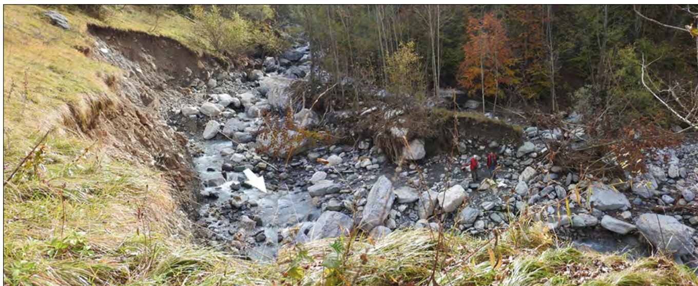
Figura 189. T. San Giovanni, a quota 1.180 m circa, poco a monte di Ponte di Leru, dove è stata ricostruita la sezione di deflusso della piena, che è risultata essere pari a circa 100 m 2 . In destra idrografica è presente un'estesa erosione spondale che corrisponde all'ampio piede della frana del T. San Giovanni (foto Turconi; coordinate: 44°11'20.99"N 7°35'40.09"E).
