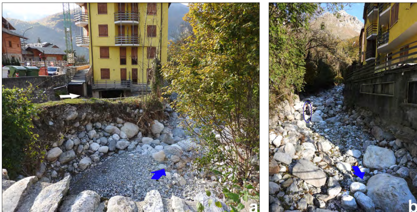
Figura 199. Erosioni spondali prodotte lungo il T. Alpellina (freccia blu) a scapito di un esile sotto pseudo-naturale (a) che separa l'alveo dalla rampa di discesa ai garage sotterranei del condominio (freccia bianca); l'acqua e il materiale lapideo di pezzatura medio-fine sono penetrati nella base del condominio dalle finestrate presenti nel muro di contenimento dell'ampio vano adibito a rimessa per le auto (foto Turconi).
