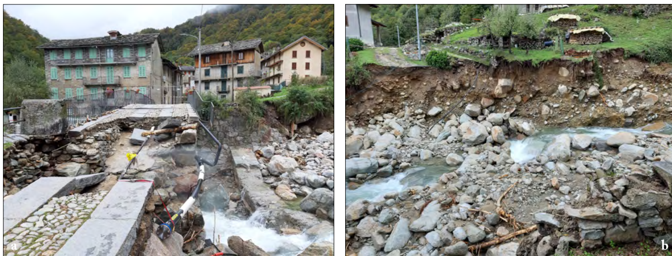
Figura 237. Piedicavallo, Torrente Mologna: a) danni al ponte della strada antica; b) erosione spondale in corrispondenza della passerella pedonale distrutta.
