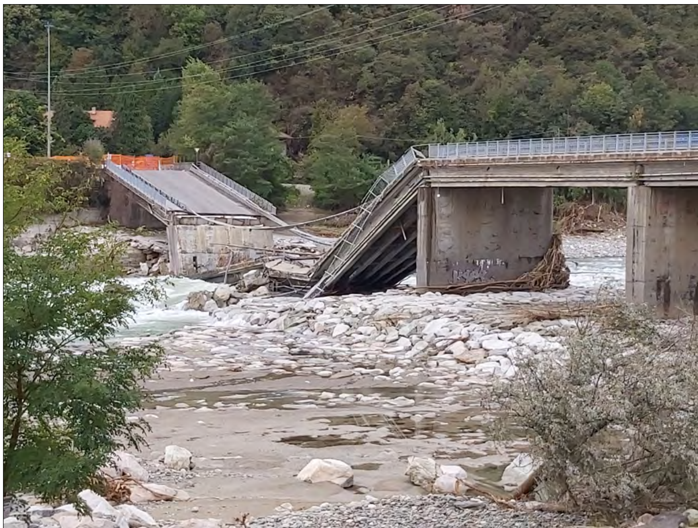
Figura 229. Il ponte che collega Gattinara e Romagnano ha subito il crollo di una pila e di due impalcati.
