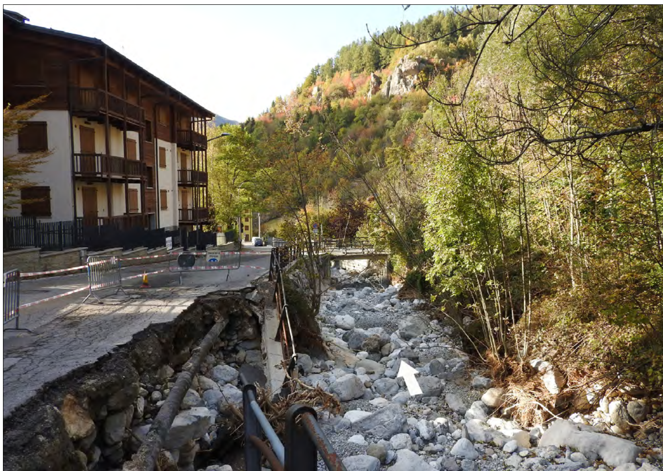
Figura 198. Vistose erosioni laterali prodotte dal T. Almellina a scapito della viabilità comunale (foto Turconi).
