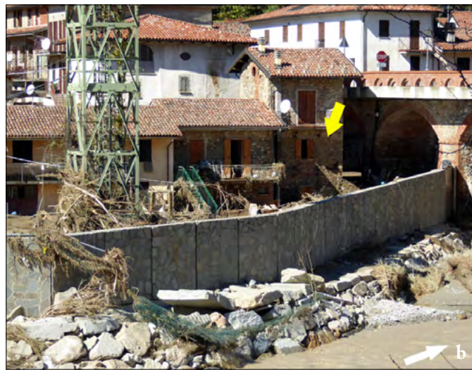
Figura 40b. Nucetto. La freccia gialla indica il livello raggiunto dalle acque nell'abitazione prossima al ponte principale del paese (visibile sulla destra) (foto Luino).
