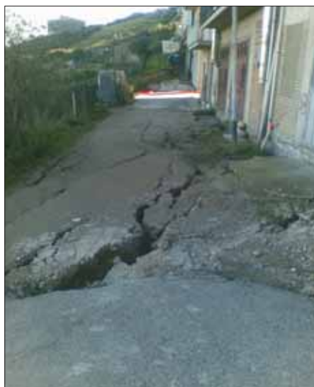
Figura 4 – Quartiere Riana, alcuni aspetti del dissesto.
