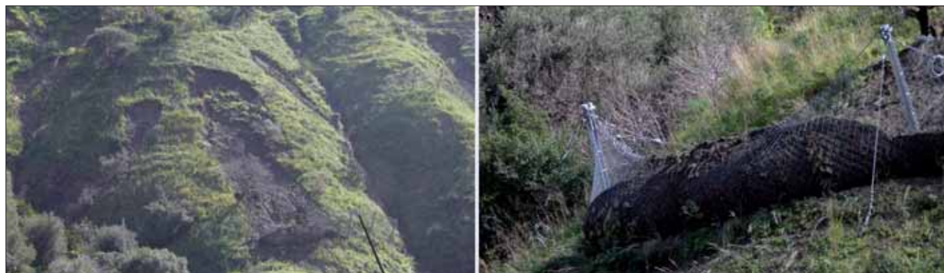
Figura 15 – Sinistra: vista generale della frana e della barriera impattata presso Scaletta Zanclea (ME). Destra: vista ravvicinata della barriera impattata.
