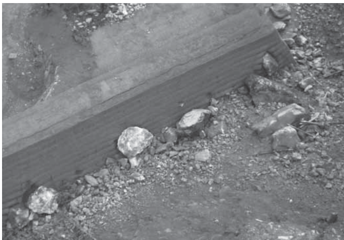
Figura 8. Visione aerea del rilevato con i blocchi da esso arrestati (evidenziata dalla freccia la fascia di rottura nell'opera).
