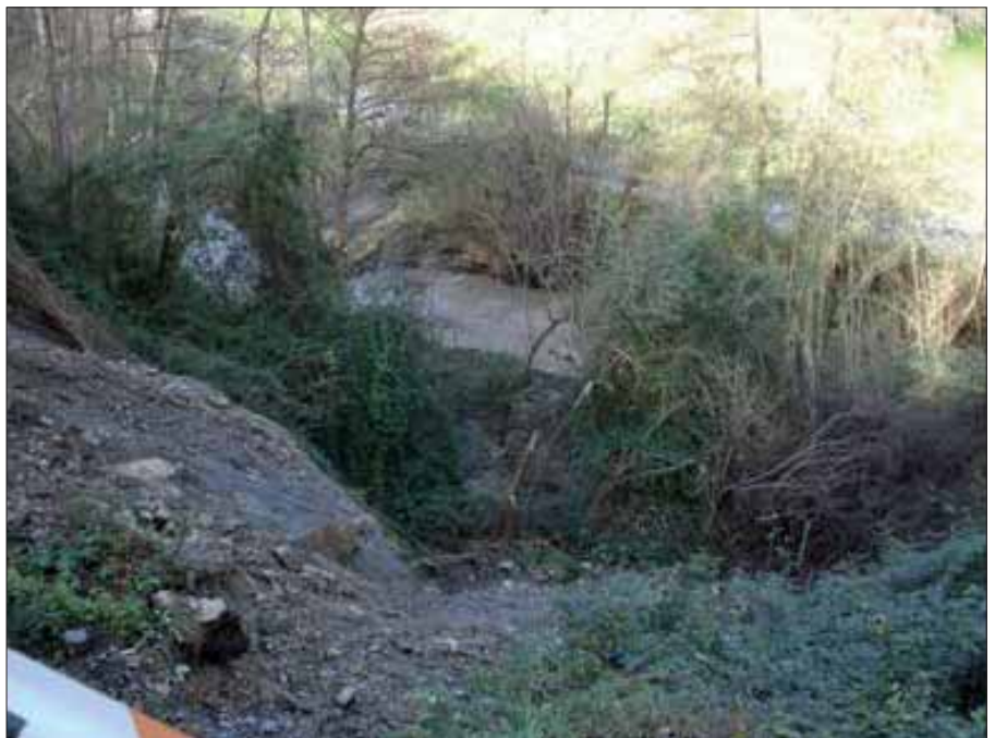
Figura 5. Scarpa di frana fotografata dalla porzione di strada non ancora crollata
