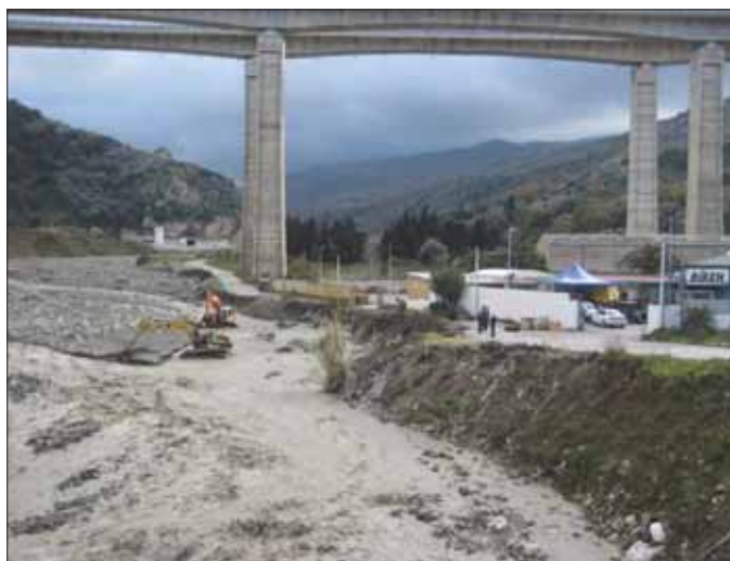
Figura 4 – Strada, lungo il T.te Inganno, erosa dalla piena del 18/02/2011 (1 vittima).
