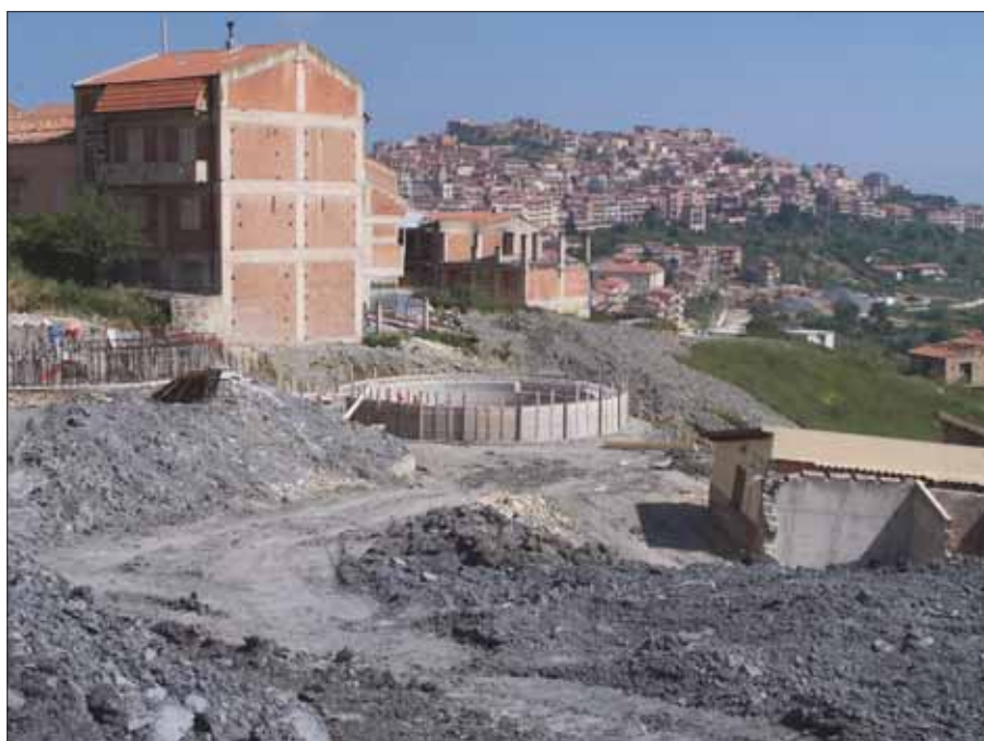
Figura 16 – Pozzi strutturali drenanti e paratie ad arco a San Benedetto.
