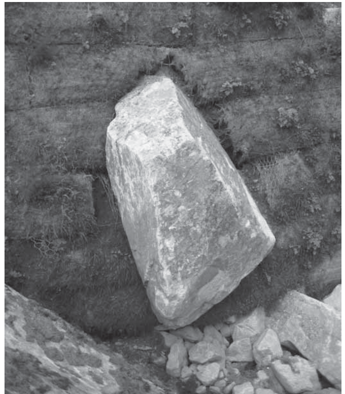
Figura 7. Particolare del blocco che ha impattato sul rilevato.
