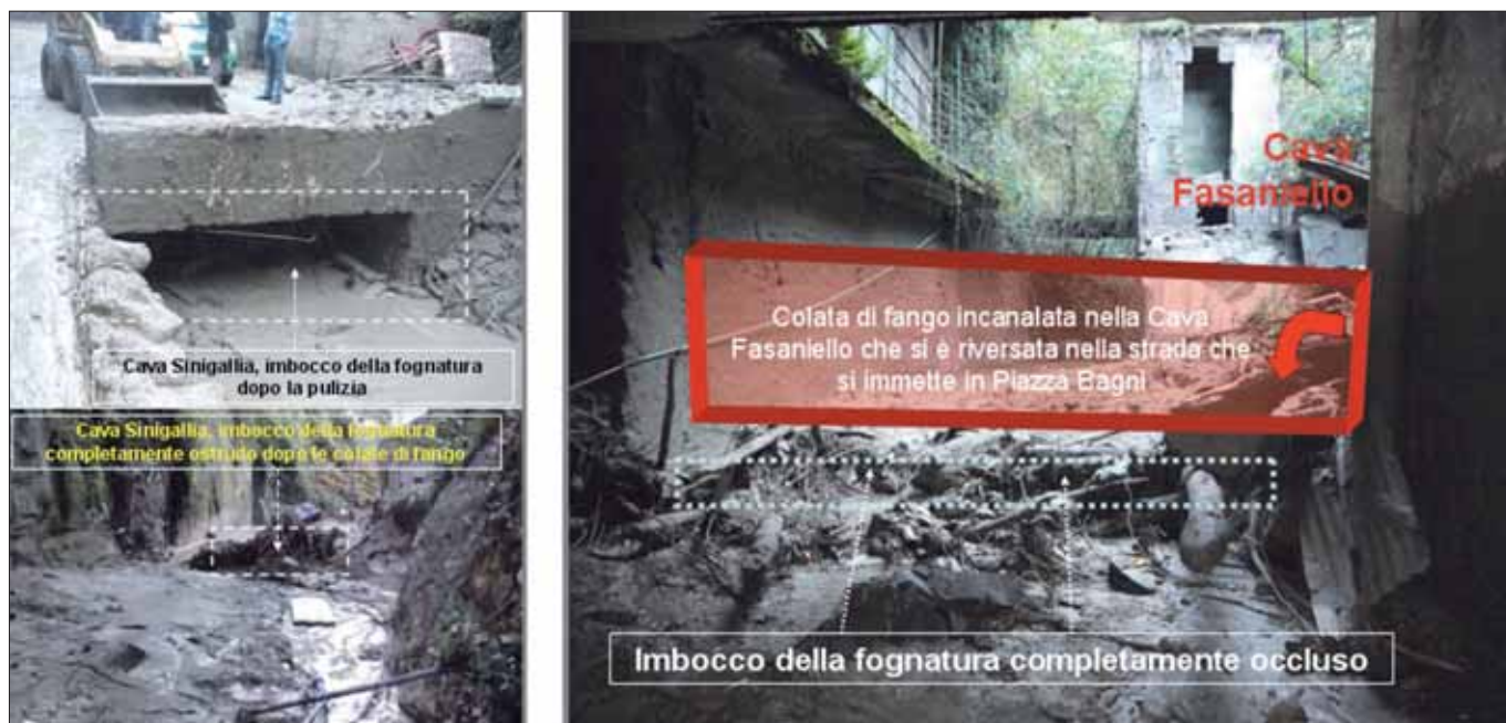
Figura 18 (a sinistra): Il passaggio dall'alveo naturale all'alveo strada del Vallone (cava) Sinigallia poche decine di metri a monte dell'abitato di Casamicciola, assolutamente insufficiente per smaltire i flussi fangoso-detritici come quello del 10 novembre 2009. Figura 20: Il passaggio dall'alveo naturale all'alveo strada del Vallone (cava) Fasanietto poche decine di metri a monte dell'abitato di Casamicciola, assolutamente insufficiente per smaltire i flussi fangoso-detritici come quello del 910 novembre 2009.
