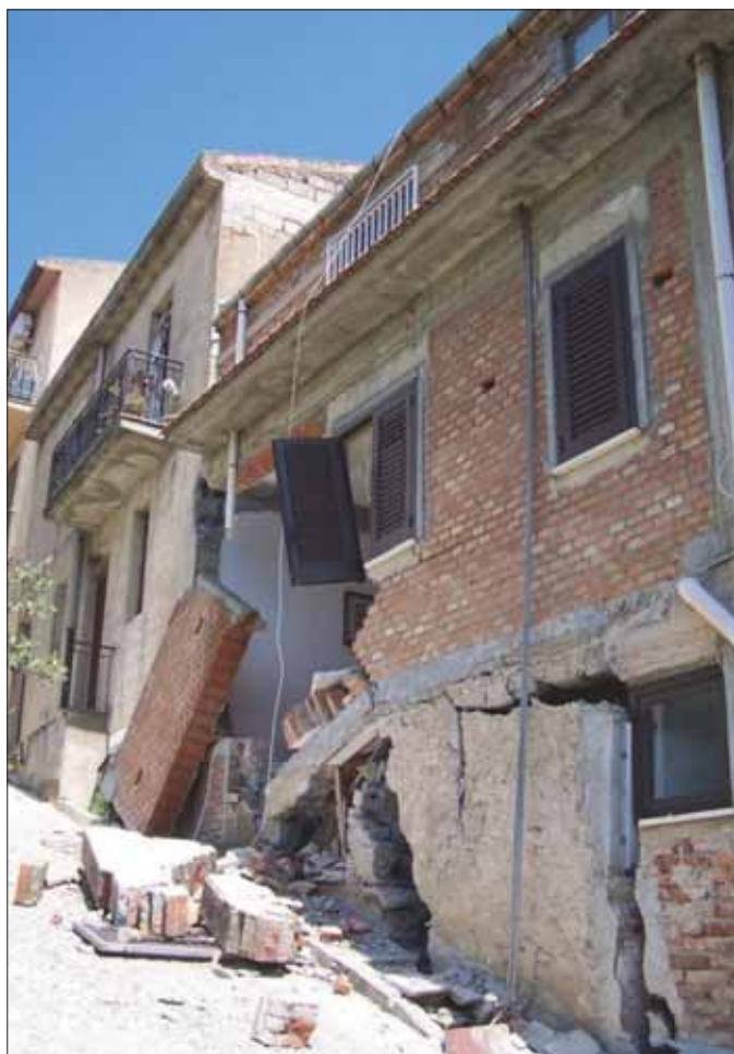
Figura 6 – Edifici distrutti nel quartiere Stazzone.
