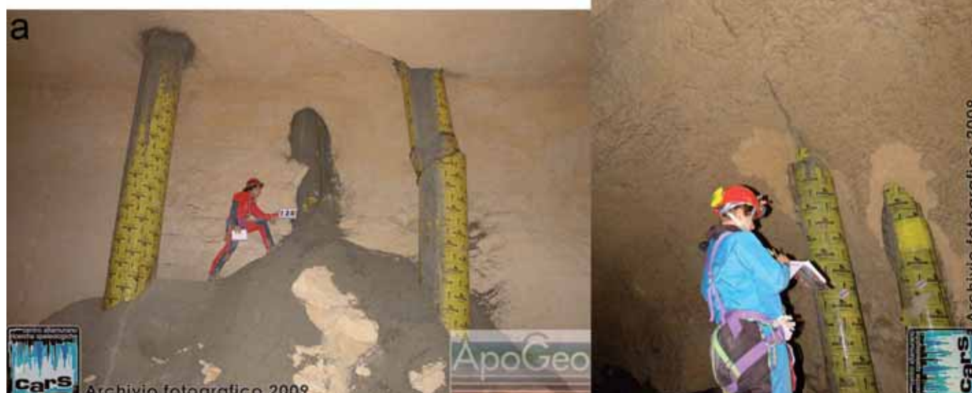
Figura 1 – Pali di fondazione all'interno di cave sotterranee ad Altamura (foto: archivio CARS-Apogeo). Da notare, nella foto b), la frattura in volta, presumibilmente causata dalla realizzazione del palo.
