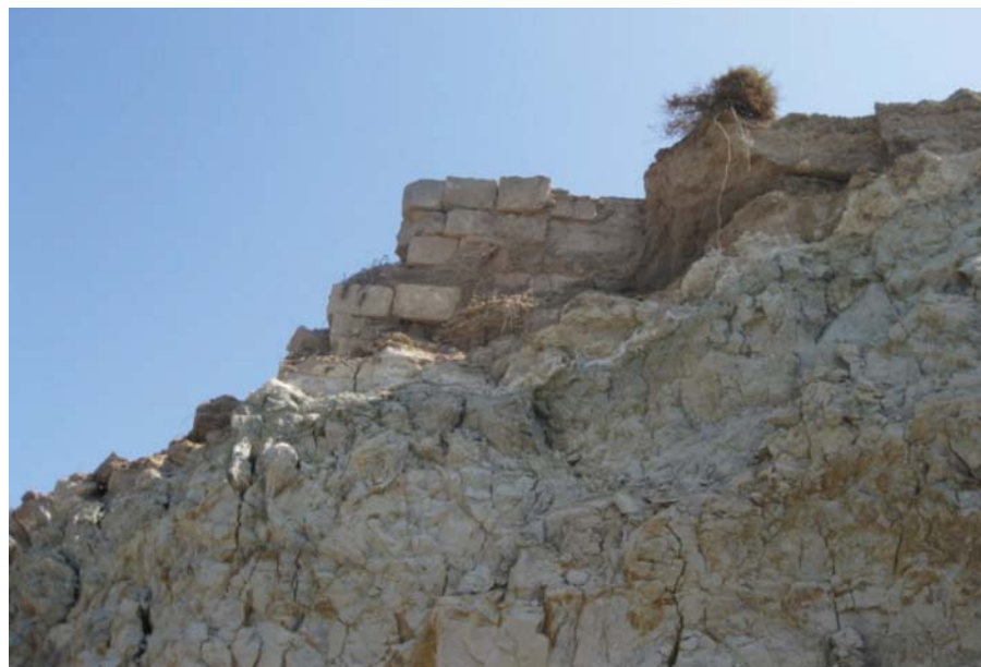
Figura 7 – La Salsola oppositifolia , è l'ultimo baluardo per le mura ormai scalzate al piede. Foto Pirrera, 2010.
