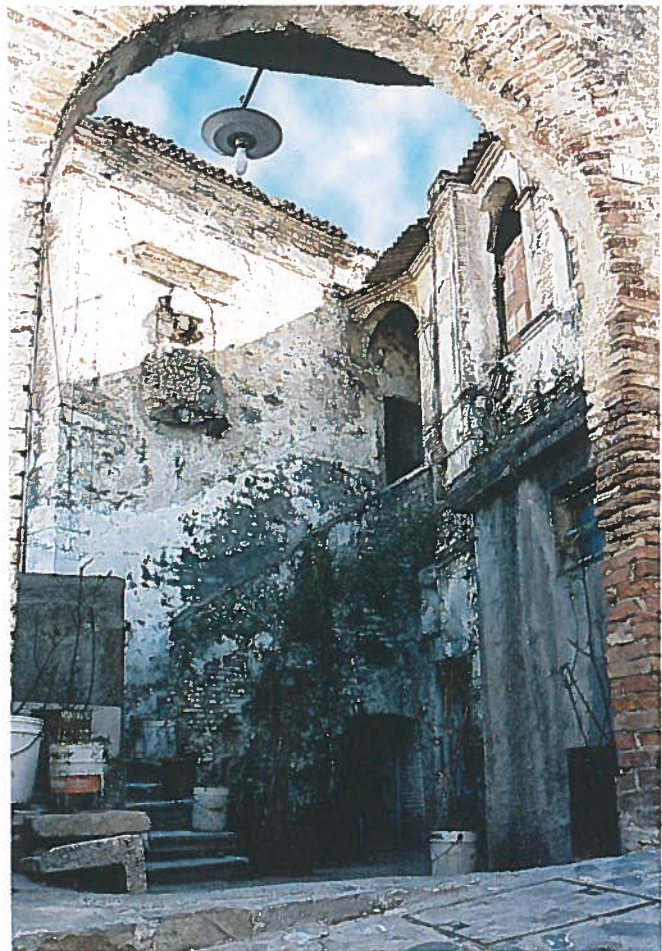
Fig. 4 - Elementi architettonici molto caratteristici interessati da fenomeni di degrado strutturale.
