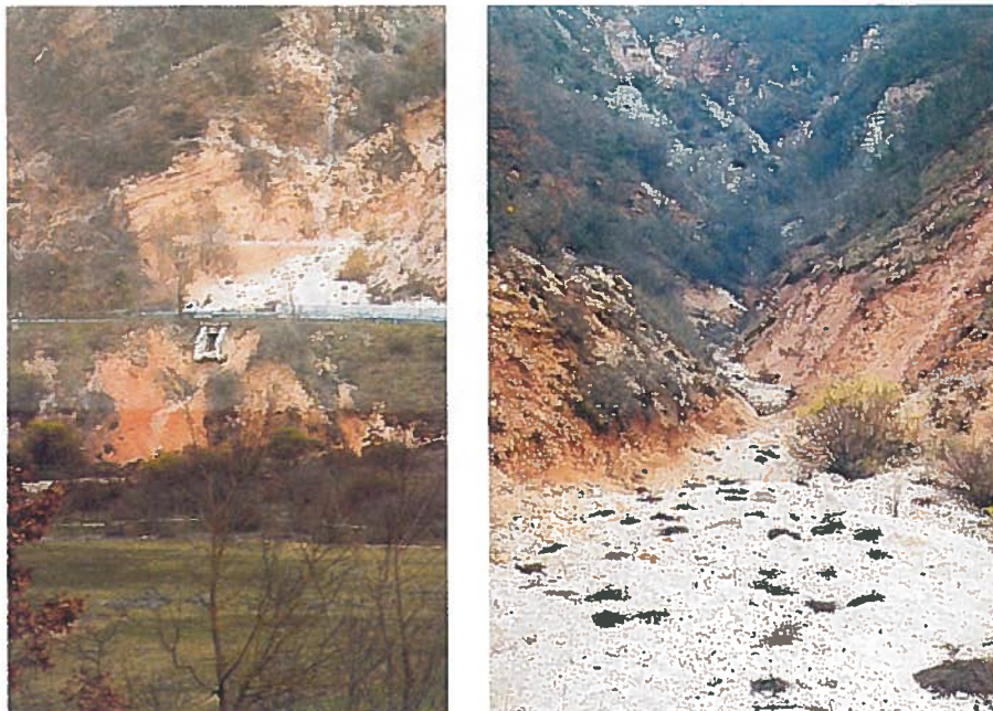
Fig.7 - Colata detritica ad ovest di Torre San Giorgio (S.S. 320 tra Serravalle e Cascia).
