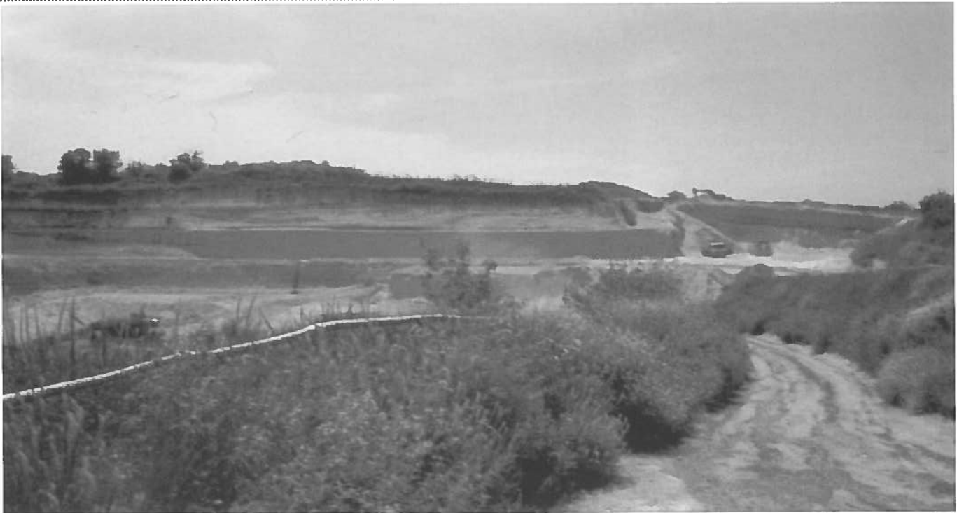
Foto 1 - Modalità di scavo, gradonatura e messa in sicurezza dei fronti di cava.
