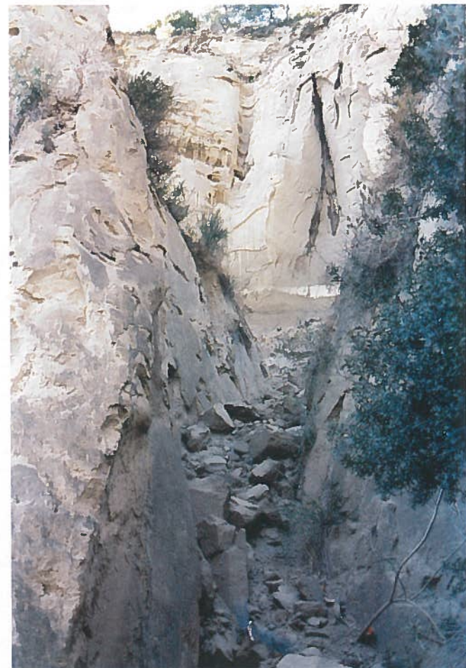
Fig. 5 - Fenomeni di sfettamento e di erosione lungo un'incisione ubicata a valle del quartiere.
