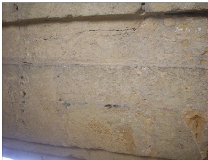
Foto 9. Lineazioni di rottura alla base di una parete interna del Palazzo Municipale
