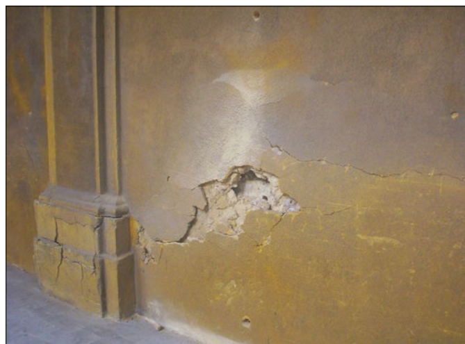
Foto 10. Evidenti segni di disagio statico con distacco del rivestimento nel muro confinante con la Chiesa di San Francesco
