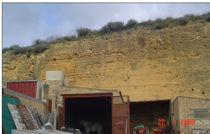
Foto 3. Parete a taglio verticale in una cava in disuso di Via Agrigento. Le calcareniti presentano condizioni di autoportanza che escludono fenomeni di crollo
