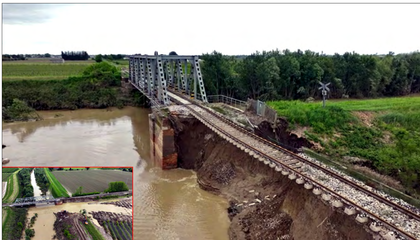
Figura 8. Parziale asportazione del rilevato ferroviario tra Sant'Agata sul Santerno e Lugo ad opera delle acque del Fiume Santerno (da un frame di un filmato del TGR)
