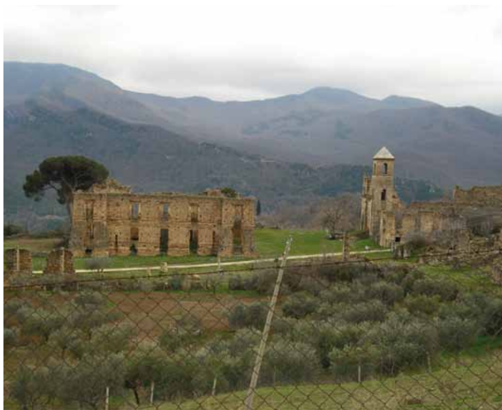
Fig. 3 - Edifici di Campomaggiore vecchio inclinati verso monte.
