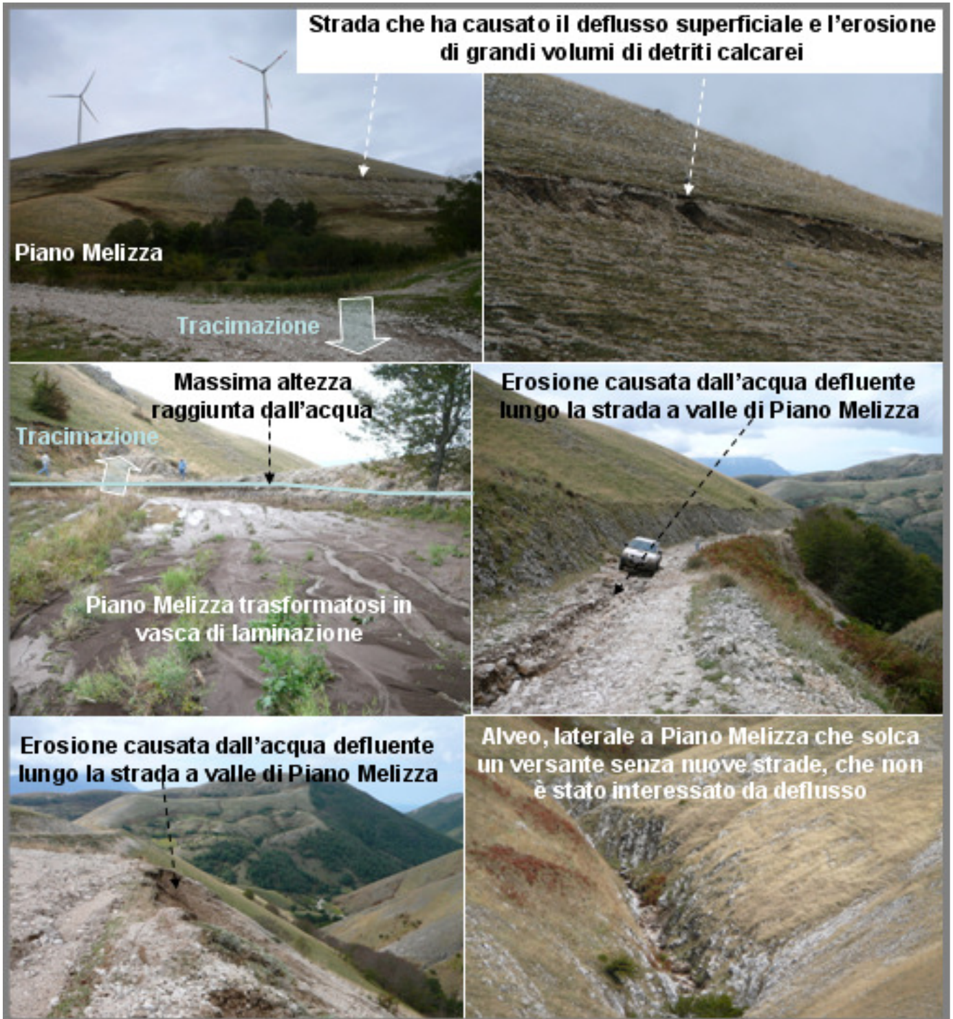
Figura 4: Esempio di inadeguata realizzazione di strade che hanno causato il potente flusso detritico di località Melizza.
